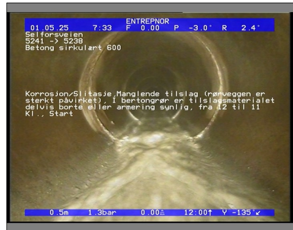
Foto: 5837_5238_5241_05022021_080352.JPG 0,5m, Korrosjon/Slitasje, Manglende tilslag (rørveggen er sterkt påvirket), I bertongrør er tilslagsmaterialet delvis borte eller armering synlig, fra 12 til 11 Kl., Start
