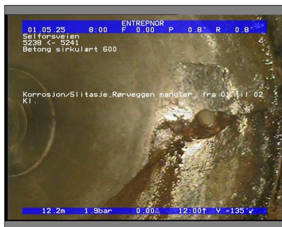
Foto: 5837_5238_5241_05022021_083135.JPG 25,26m, Korrosjon/Slitasje, Rørveggen mangler, fra 10 til 11 Kl.
