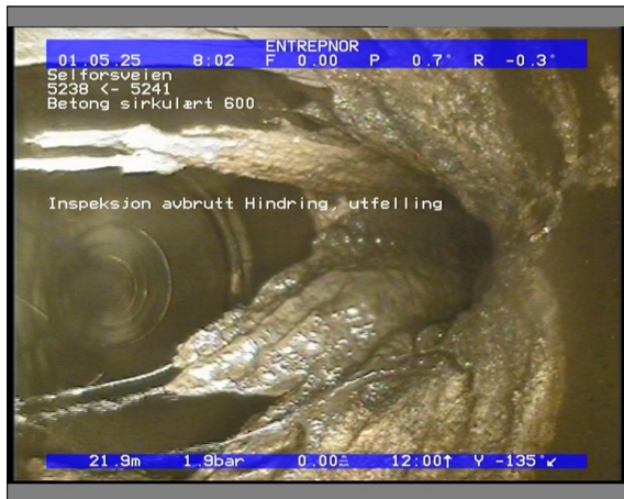
Foto: 5837_5238_5241_05022021_083350.JPG 15,58m, Inspeksjon avbrutt Hindring, utfelling
