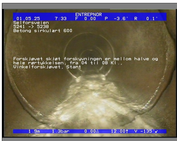
Foto: 5837_5238_5241_05022021_080410.JPG 1,9m, Førskjøvet skjøt forskyvningen er mellom halve og hele rørtykkelsen, fra 04 til 08 Kl., Vinkelførskjøvet, Start
