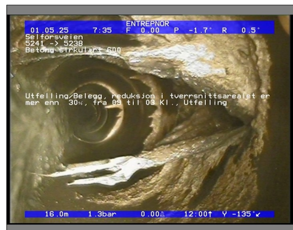
Foto: 5837_5238_5241_05022021_080636.JPG 16,08m, Utfelling/Belegg, reduksjon i tverrsnittsarealet er mer enn 30%, fra 09 til 03 Kl., Utfelling
