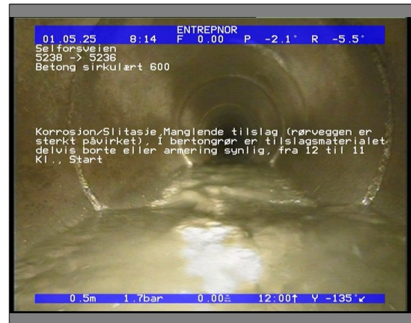
Foto: 5834_5236_5238_05022021_084523.JPG 0,5m, Korrosjon/Slitasje, Manglende tilslag (rørveggen er sterkt påvirket), I bertongrør er tilslagsmaterialet delvis borte eller armering synlig, fra 12 til 11 Kl., Start
