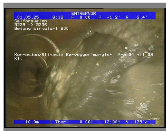
Foto: 5834_5236_5238_05022021_085026.JPG 10,06m, Korrosjon/Slitasje, Rørveggen mangler, fra 04 til 08 Kl.
