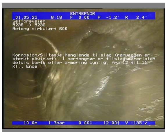
Foto: 5834_5236_5238_05022021_084940.JPG 10,05m, Korrosjon/Slitasje, Manglende tilslag (rørveggen er sterkt påvirket), I bertongrør er tilslagsmaterialet delvis borte eller armering synlig, fra 12 til 11 Kl., Ende
