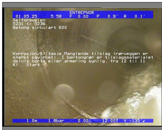
Foto: 5828_5231_5236_05022021_062010.JPG 1m, Korrosjon/Slitasje, Manglende tilslag (rørveggen er sterkt påvirket), I bertongrør er tilslagsmaterialet delvis borte eller armering synlig, fra 12 til 11 Kl., Start
