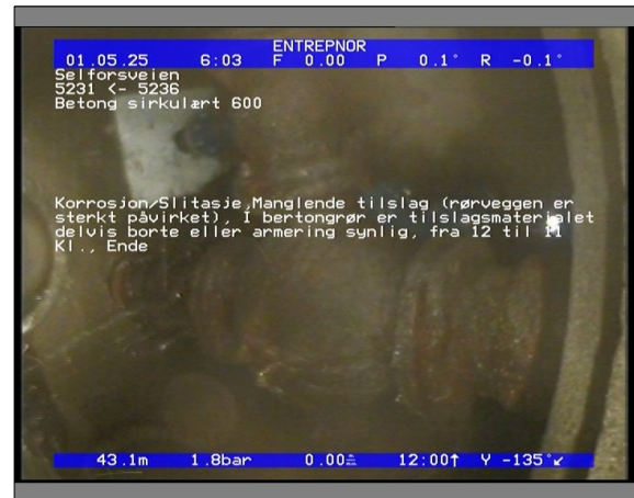
Foto: 5828_5231_5236_05022021_062544.JPG 43,11m, Korrosjon/Slitasje, Manglende tilslag (rørveggen er sterkt påvirket), I bertongrør er tilslagsmaterialet delvis borte eller armering synlig, fra 12 til 11 Kl., Ende
