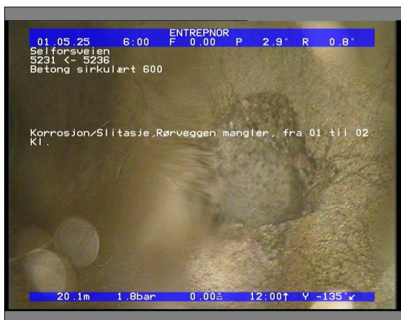
Foto: 5828_5231_5236_05022021_062215.JPG 20,17m, Korrosjon/Slitasje, Rørveggen mangler, fra 01 til 02 Kl.
