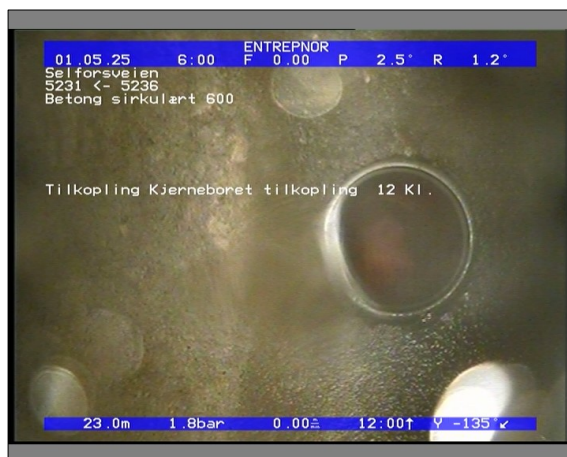
Foto: 5828_5231_5236_05022021_062252.JPG 23,08m, Tilkopling Kjerneboret tilkopling 12 Kl.
