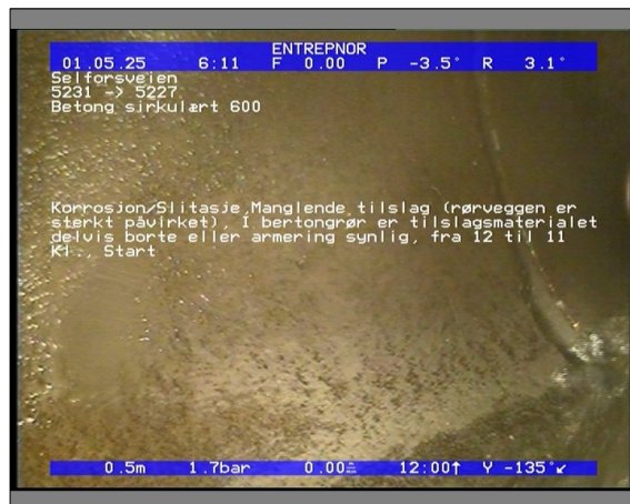
Foto: 5822_5227_5231_05022021_063350.JPG 0,5m, Korrosjon/Slitasje, Manglende tilslag (rørveggen er sterkt påvirket), I bertongrør er tilslagsmaterialet delvis borte eller armering synlig, fra 12 til 11 Kl., Start
