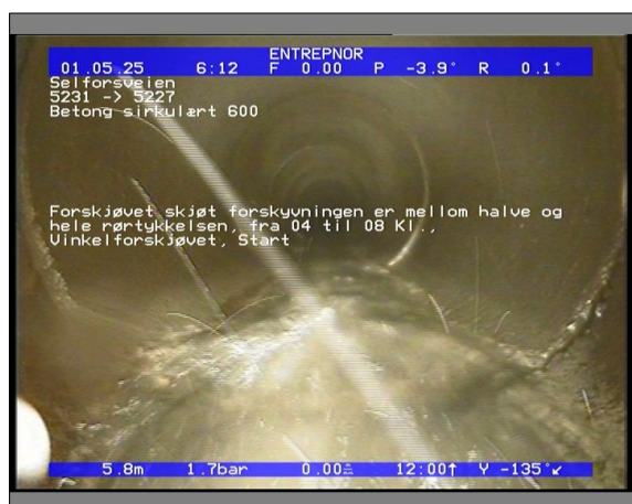
Foto: 5822_5227_5231_05022021_063428.JPG 5,86m, Forskjøvet skjøt forskyvningen er mellom halve og hele rørtykkelsen, fra 04 til 08 Kl., Vinkelforskjøvet, Start
