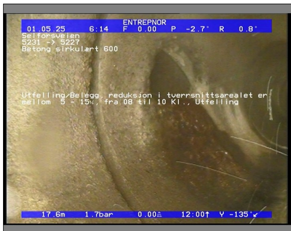
Foto: 5822_5227_5231_05022021_063611.JPG 17,67m, Utfelling/Belegg, reduksjon i tvernsnittarealet er mellom 5 - 15%, fra 08 til 10 Kl., Utfelling
