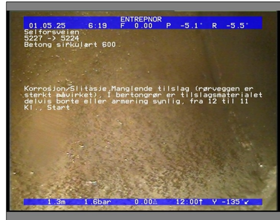
Foto: 5820_5224_5227_05022021_064149.JPG 1,3m, Korrosjon/Slitasje, Manglende tilslag (rørveggen er sterkt påvirket), I bertongrør er tilslagsmaterialet delvis borte eller armering synlig, fra 12 til 11 Kl., Start
