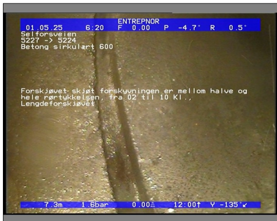
Foto: 5820_5224_5227_05022021_064254.JPG 7,39m, Forskjøvet skjøt forskyvningen er mellom halve og hele rørtykkelsen, fra 02 til 10 Kl., Lengdeforskjøvet
