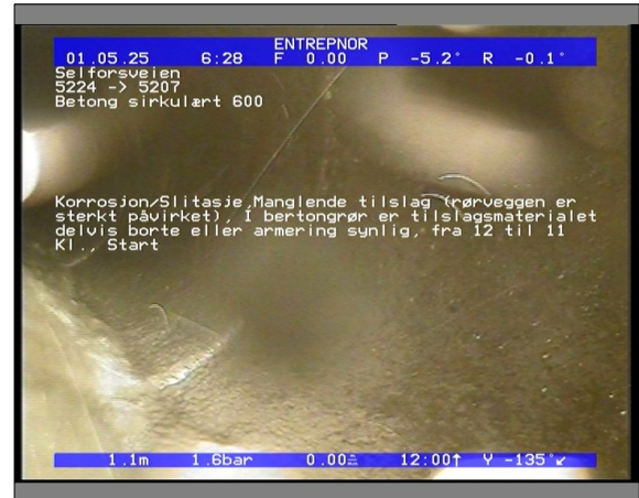
Foto: 5814_5207_5224_05022021_065024.JPG 1,17m, Korrosjon/Slitasje, Manglende tilslag (rørveggen er sterkt påvirket), I bertongrør er tilslagsmaterialet delvis borte eller armering synlig, fra 12 til 11 Kl., Start
