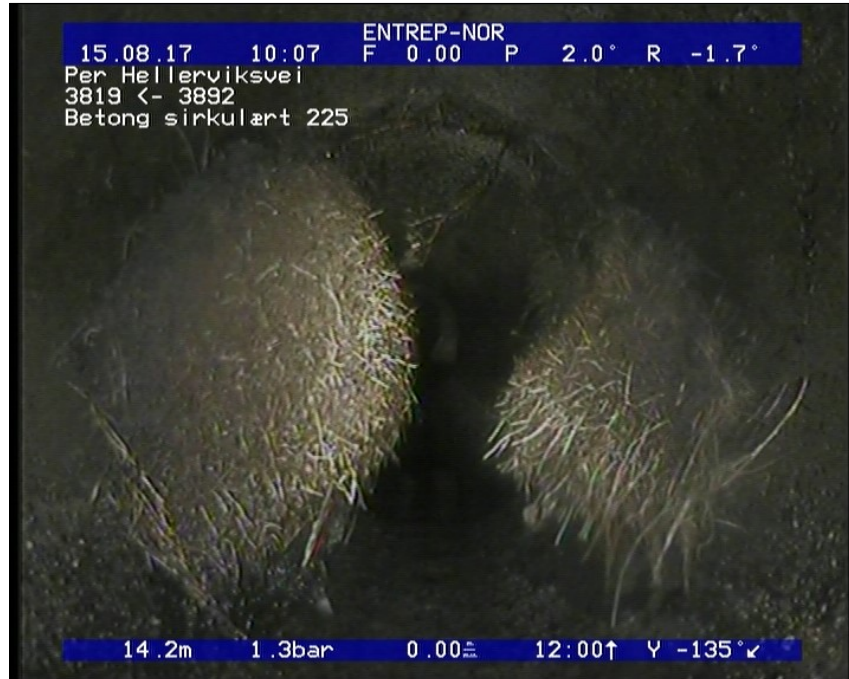
Foto: 101_101_459_A.JPG 14,25m, Røtter, reduksjon i tverrsnittsarealet er mer enn 30%, fra 07 til 05 Kl., Sammenfiltrede røtter / rottugge
