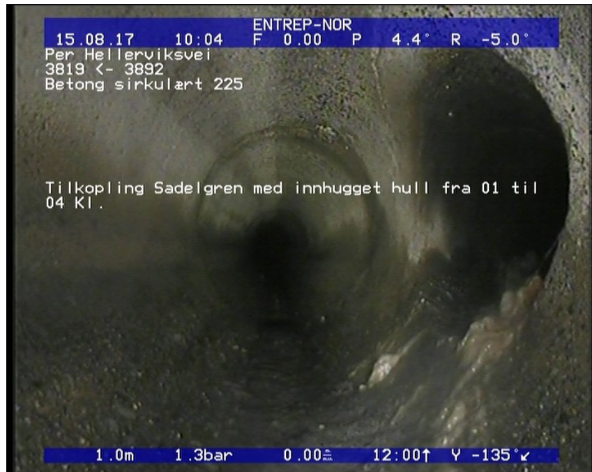
Foto: 101_101_456_A.JPG 1,06m, Tilkopling Sadelgren med innhugget hull fra 01 til 04 Kl.
