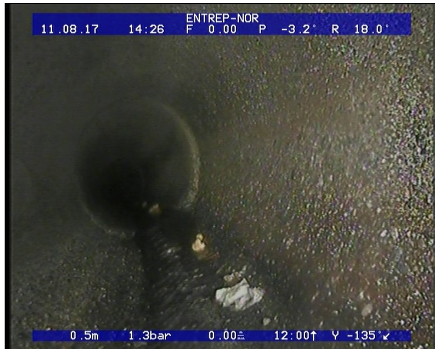
Foto: 15_15_438_A.JPG 0,5m, Korrosjon/Slitasje Synlig tilslag (rørveggen er betydelig påvirket), I betongrør er tilslagsmaterialet tydelig blottlagt, fra 04 til 08 Kl., Start
