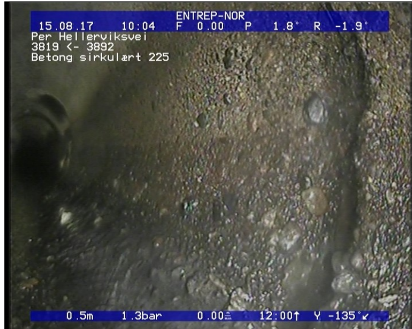
Foto: 101_101_455_A.JPG 0,58m, Forskjøvet skjøt forskyvningen er mellom halve og hele rørtykkelsen, fra 12 til 12 Kl., Lengdeforskjøvet, Start
