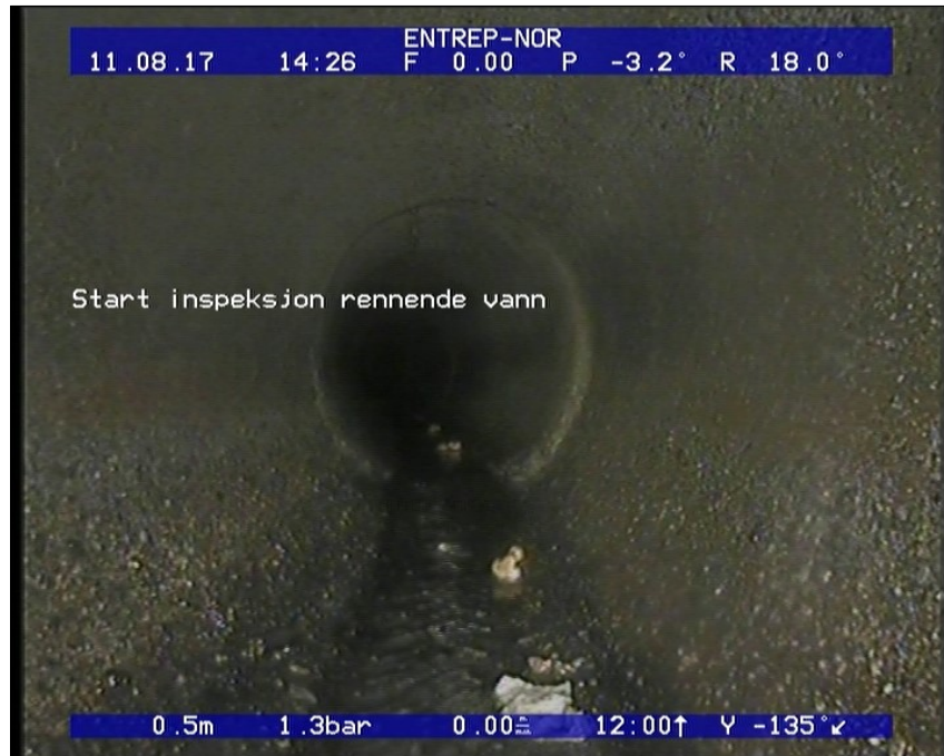
Foto: 15_15_15_A.JPG 0,5m, Start inspeksjon rennende vann
