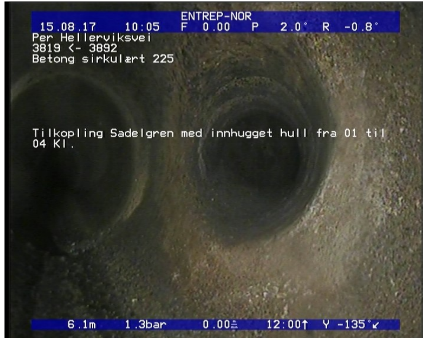
Foto: 101_101_457_A.JPG 6,15m, Tilkopling Sadelgren med innhugget hull fra 01 til 04 Kl.
