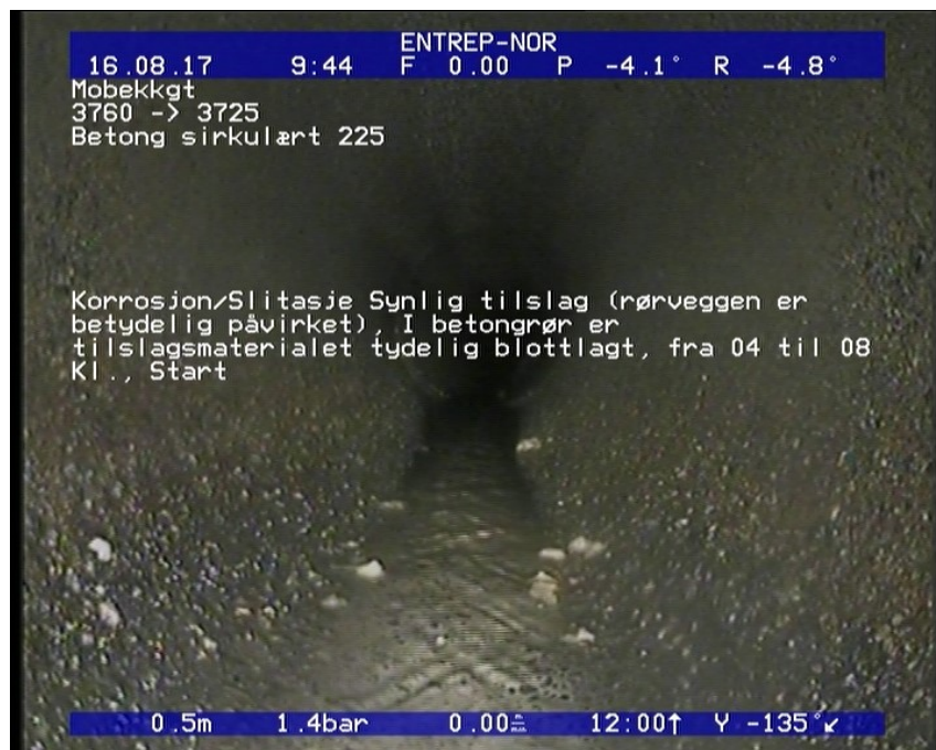
Foto: 2_2_510_A.JPG 0,5m, Korrosjon/Slitasje Synlig tilslag (rørveggen er betydelig påvirket), I betongrør er tilslagsmaterialet tydelig blottlagt, fra 04 til 08 Kl., Start
