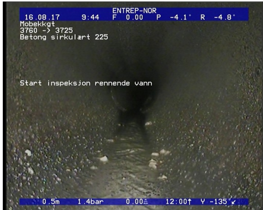
Foto: 2_2_2_A.JPG 0,5m, Start inspeksjon rennende vann
