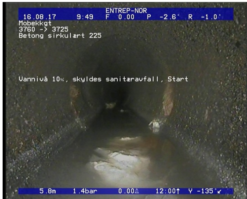
Foto: 2_2_521_A.JPG 5,87m, Vannivå 10%, skyldes sanitærafvall, Start
