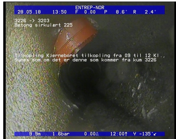
Foto: Tilkopling Kjerneboret tilkopling fra 09 til 12 Kl., Synes som om det er denne som kommer fra k.JPG 9,92m, Tilkopling Kjerneboret tilkopling fra 09 til 12 Kl., Synes som om det er denne som kommer fra kum 3226
