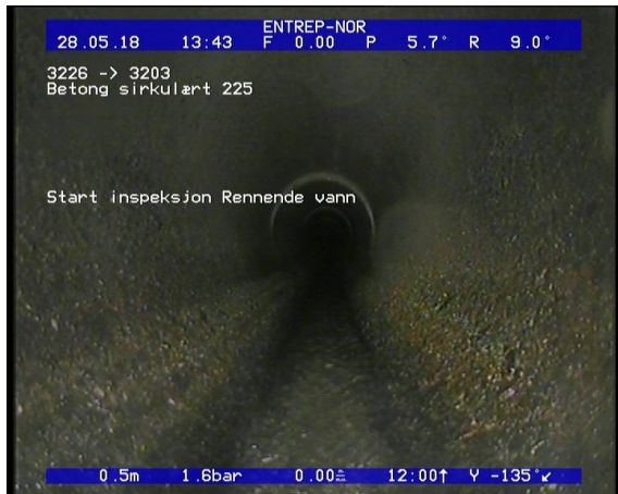
Foto: Start inspeksjon Rennende vann_1346310,5_SI.JPG 0,5m, Start inspeksjon Rennende vann
