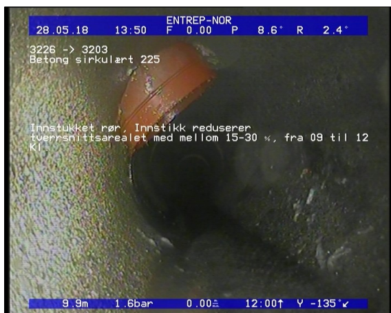
Foto: Innstukket rør, Innstikk reduserer tverrsnittsarealet med mellom 15-30 %, fra 09 til 12 Kl._135.JPG 9,92m, Innstukket rør, Innstikk reduserer tverrsnittsarealet med mellom 15-30 %, fra 09 til 12 Kl.
