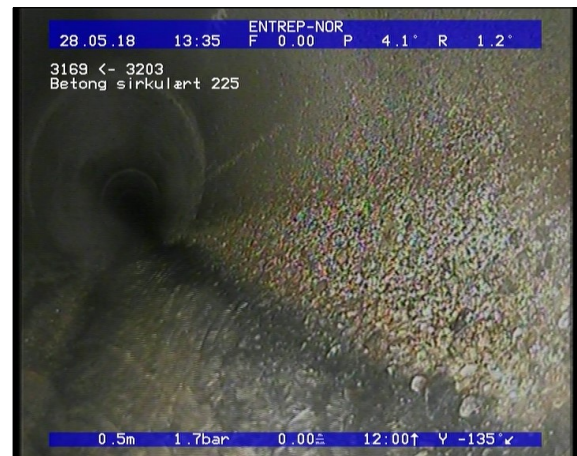
Foto: Korrosjon/Slitasje Synlig tilslag (rørveggen er betydelig påvirket), I betongrør er tilslagsmat.JPG 0,5m, Korrosjon/Slitasje Synlig tilslag (rørveggen er betydelig påvirket), I betongrør er tilslagsmaterialet tydelig blottlagt, fra 04 til 08 Kl., Start
