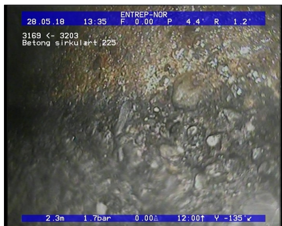
Foto: Korrosjon/Slitasje, Manglende tilslag (rørveggen er sterkt påvirket), I bertongrør er tilslagsma.JPG 2,35m, Korrosjon/Slitasje, Manglende tilslag (rørveggen er sterkt påvirket), I bertongrør er tilslagsmaterialet delvis borte eller armering synlig, fra 04 til 08 Kl., Start
