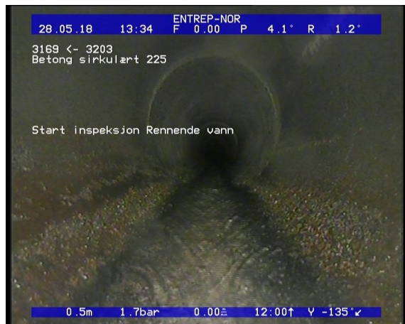
Foto: Start inspeksjon Rennende vann_1338070,5_SI.JPG 0,5m, Start inspeksjon Rennende vann
