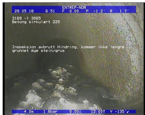
Foto: Inspeksjon avbrutt Hindring, kommer ikke lengre grunnet mye stein/grus_0654234,05_IA.JPG 4,05m, Inspeksjon avbrutt Hindring, kommer ikke lengre grunnet mye stein/grus
