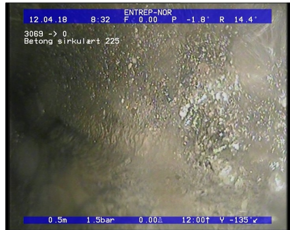
Foto: Korrosjon/Slitasje Synlig tilslag (rørveggen er betydelig påvirket), I betongrør er tilslagsmat.JPG 0,59m, Korrosjon/Slitasje Synlig tilslag (rørveggen er betydelig påvirket), I betongrør er tilslagsmaterialet tydelig blottlagt, fra 04 til 08 Kl., Start
