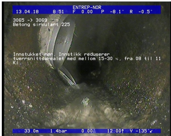
Foto: Innstukket rør, Innstikk reduserer tverrsnittsarealet med mellom 15-30 %, fra 08 til 11 Kl.,_085.JPG 33,01m, Innstukket rør, Innstikk reduserer tverrsnittsarealet med mellom 15-30 %, fra 08 til 11 Kl.
