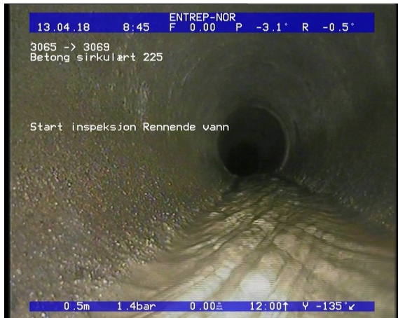
Foto: Start inspeksjon Rennende vann_0849270,5_SI.JPG 0,5m, Start inspeksjon Rennende vann
