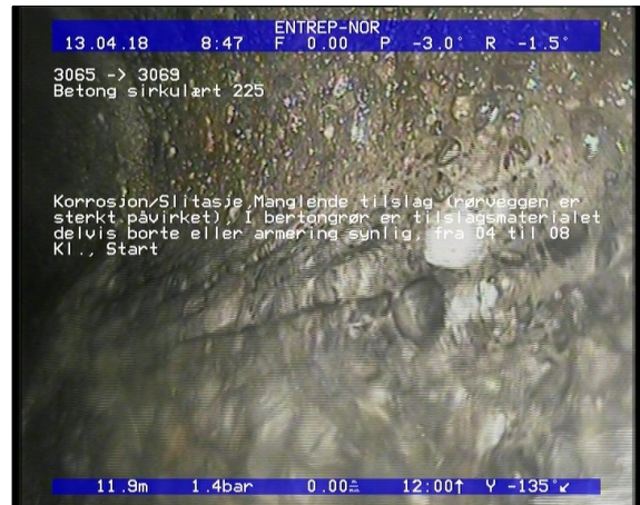
Foto: Korrosjon/Slitasje, Manglende tilslag (rørveggen er sterkt påvirket), I bertongrør er tilslagsma.JPG 11,91m, Korrosjon/Slitasje, Manglende tilslag (rørveggen er sterkt påvirket), I bertongrør er tilslagsmaterialet delvis borte eller armering synlig, fra 04 til 08 Kl., Start
