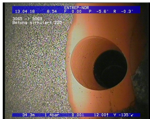
Foto: Tilkobling Prefabrikkert grennrør, fra 02 til 04 Kl., Ikke avmerket i tegning_08583634,22_TK.JPG 34,22m, Tilkobling Prefabrikkert grennrør, fra 02 til 04 Kl., Ikke avmerket i tegning
