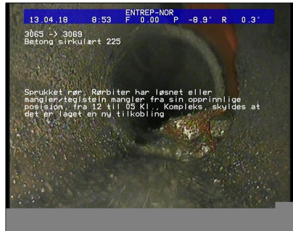
Foto: Sprukket rør, Rørbiter har løsnet eller mangler/teglstein mangler fra sin opprinnlige posisjon, JPG 34,22m, Sprukket rør, Rørbiter har løsnet eller mangler/teglstein mangler fra sin opprinnlige posisjon, fra 12 til 05 Kl., Kompleks, skyldes at det er laget en ny tilkobling
