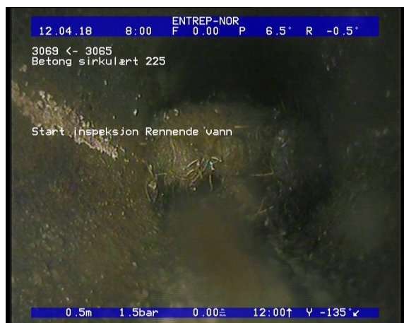
Foto: Start inspeksjon Rennende vann_0804310,5_SI.JPG 54,81m, Start inspeksjon Rennende vann
