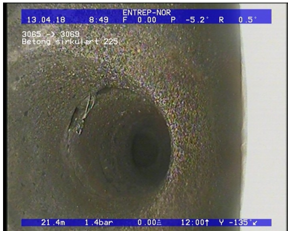
Foto: Tilkopling Prefabrikkert grenrør. fra 11 til 01 Kl., Ikke avmerket i tegning_08533121,06_TK.JPG 21,06m, Tilkopling Prefabrikkert grenrør. fra 11 til 01 Kl., Ikke avmerket i tegning
