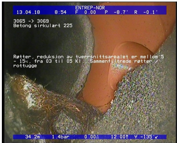
Foto: Røtter, reduksjon av tverrsnittsarealet er mellom 5 - 15, fra 03 til 05 Kl., Sammenfiltrede røtter.JPG 34,22m, Røtter, reduksjon av tverrsnittsarealet er mellom 5 - 15%, fra 03 til 05 Kl., Sammenfiltrede røtter / rottugge
