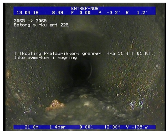
Foto: Tilkopling Prefabrikkert grennrør, fra 11 til 01 Kl., Ikke avmerket i tegning_08531721,06_TK.JPG 21,06m, Tilkopling Prefabrikkert grennrør, fra 11 til 01 Kl., Ikke avmerket i tegning
