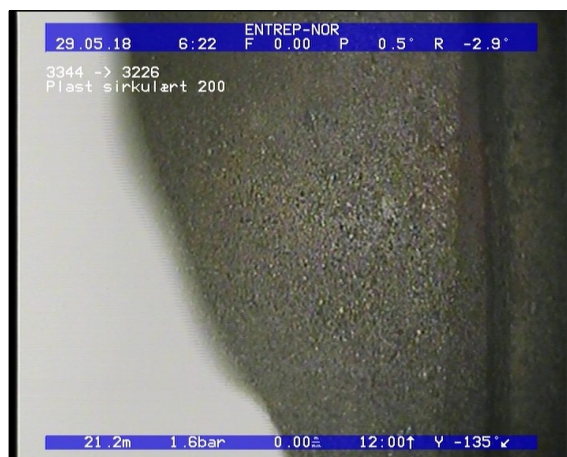
Foto: Inspeksjon avbrutt Høyt vannivå._06261521,24_IA.JPG 21,24m, Inspeksjon avbrutt Høyt vannivå.
