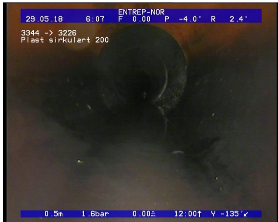
Foto: Start inspeksjon Rennende vann_0610370,5_SI.JPG 0,5m, Start inspeksjon Rennende vann
