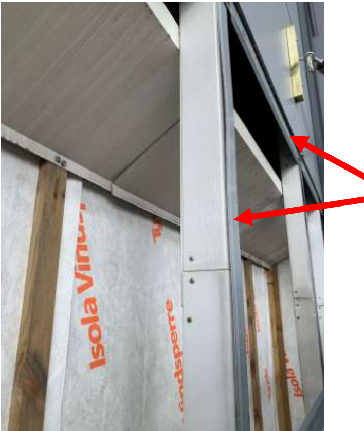
Foto 3: Deler av dagens løsning. Her sees de vertikale profilene. Disse må få bedre samvirke. Videre sees de horisontale profilene. Det skal monteres inn flere horisontale profiler. Røde piler peker på de tynne aluminiumsbåndene/dekkprofilene som må demonteres, tas vare på og monteres.
