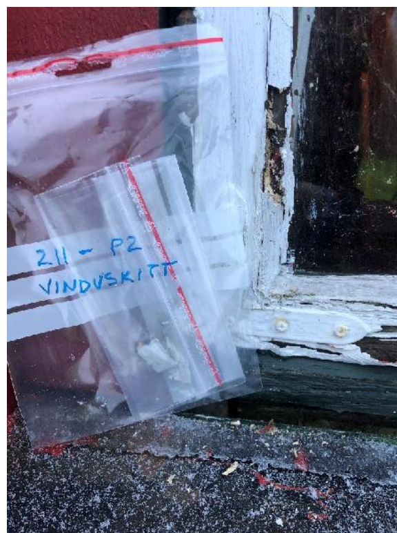
Bilde 8: Prøve 211 – P2, vinduskitt
