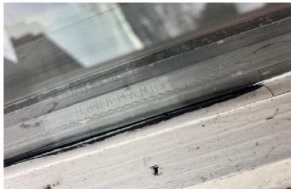
Bilde 26: Eksempel på isolerglassvindu med klorparafiner
