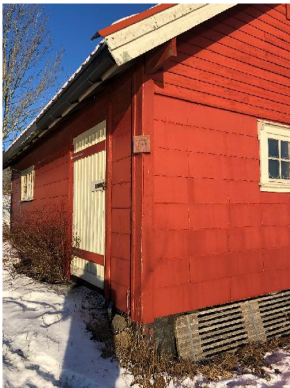
Bilde 9: Asbestholdige fasadeplater kledd vegg sjøhus (nr. 195)
