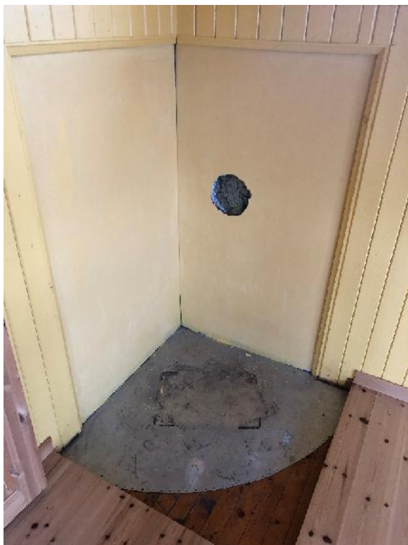
Bilde 13: Prøve 205 – P1, brannmur plate - asbest påvist!
