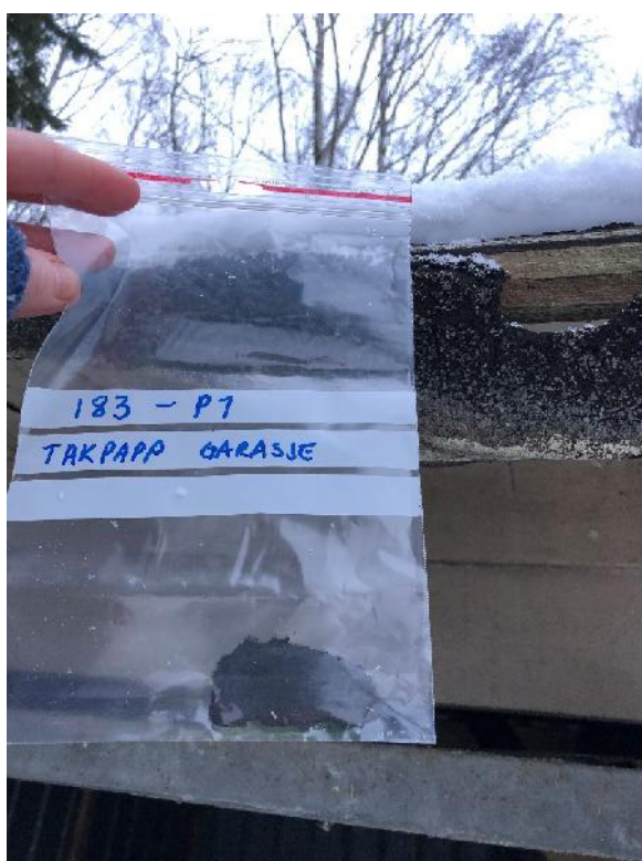
Bilde 5: Prøve 183 – P1, takpapp garasje
