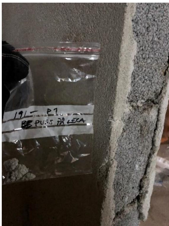
Bilde 1: Prøve 191 – P1, puss på lecavegg i kjeller
