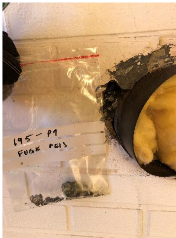
Bilde 4: Prøve 195 – P1, fuge ved peis
