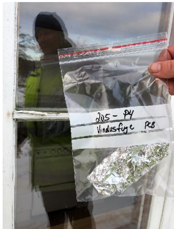
Bilde 16: Prøve 205 – P4, vindusfuge. PCB ikke påvist.
