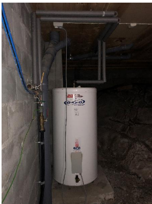
Bilde 21: Rør med cellegummi og varmtvannsbereder (VVB) (EE-avfall) (nr. 183)
