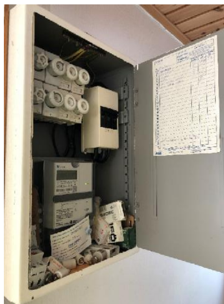
Bilde 30: Eksempel på sikring/elskap (EE-avfall)
