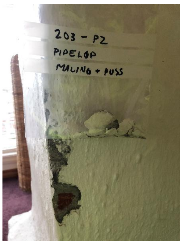
Bilde 9: Prøve 203 – P2, maling + puss
