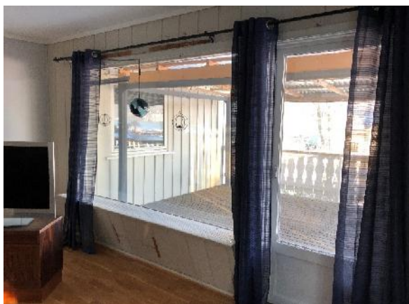
Bilde 19: Isolerglassvinduer med PCB (nr. 191)
