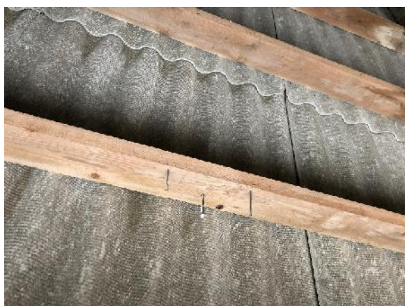
Bilde 15: Takplater med påvist asbest! (nr. 183)
