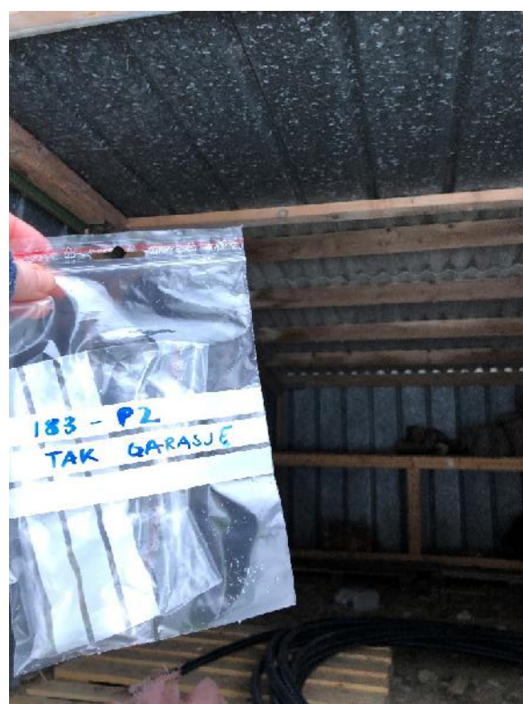
Bilde 6: Prøve 183 – P2, tak garasje – asbest påvist!
