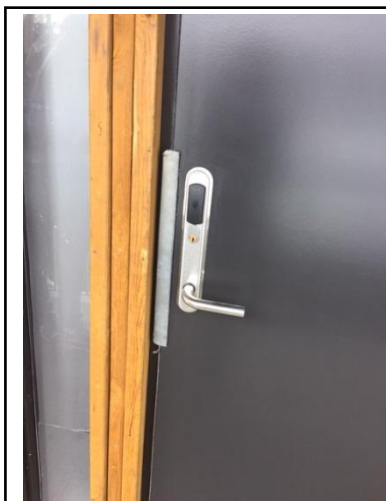
Eksempel på ekstra beskyttelse dør mht lås. Innbruddssikring
