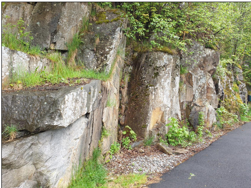
Figur 8: Berget under skolen med synlige utgående sprekkeplan.
