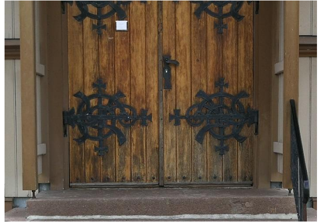
Midtre og nedre deler av hovedinngangsdør (øst) med nedbrutt overflatebehandling og misfarget trevirke.
