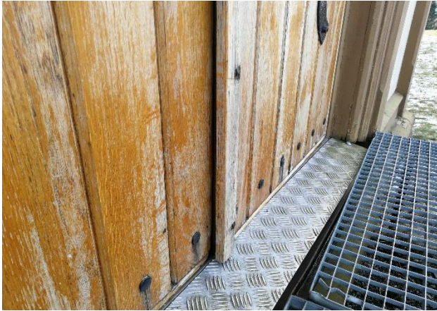
Eikedør i nordvegg i skipet. Vestre blad har slått seg og det er utettheter i anslaget mot østre blad.
