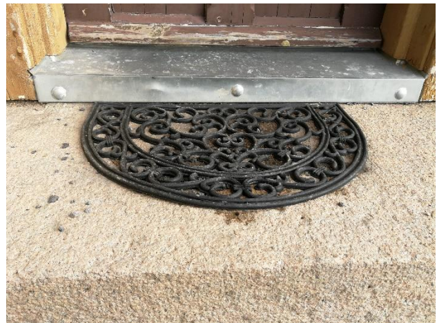
Værslitte deler nederst i dør til sakristi: maling slitt bort, bart trevirke og maling som flasser.
