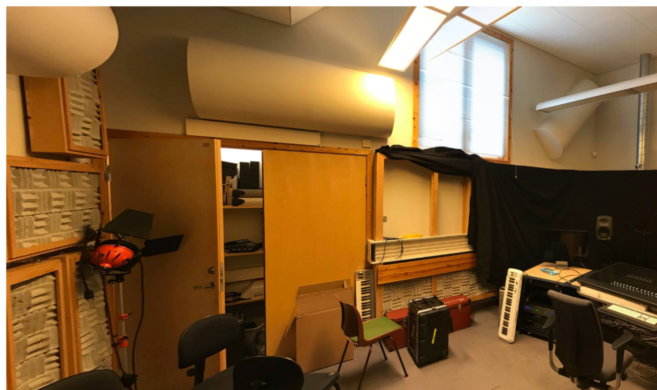
Studio - eks. bøyde gipsplater og eks. veggabsorbenter demonteres Eks. to-fløyet dør inntil lagerrom erstattes med skyvedør
