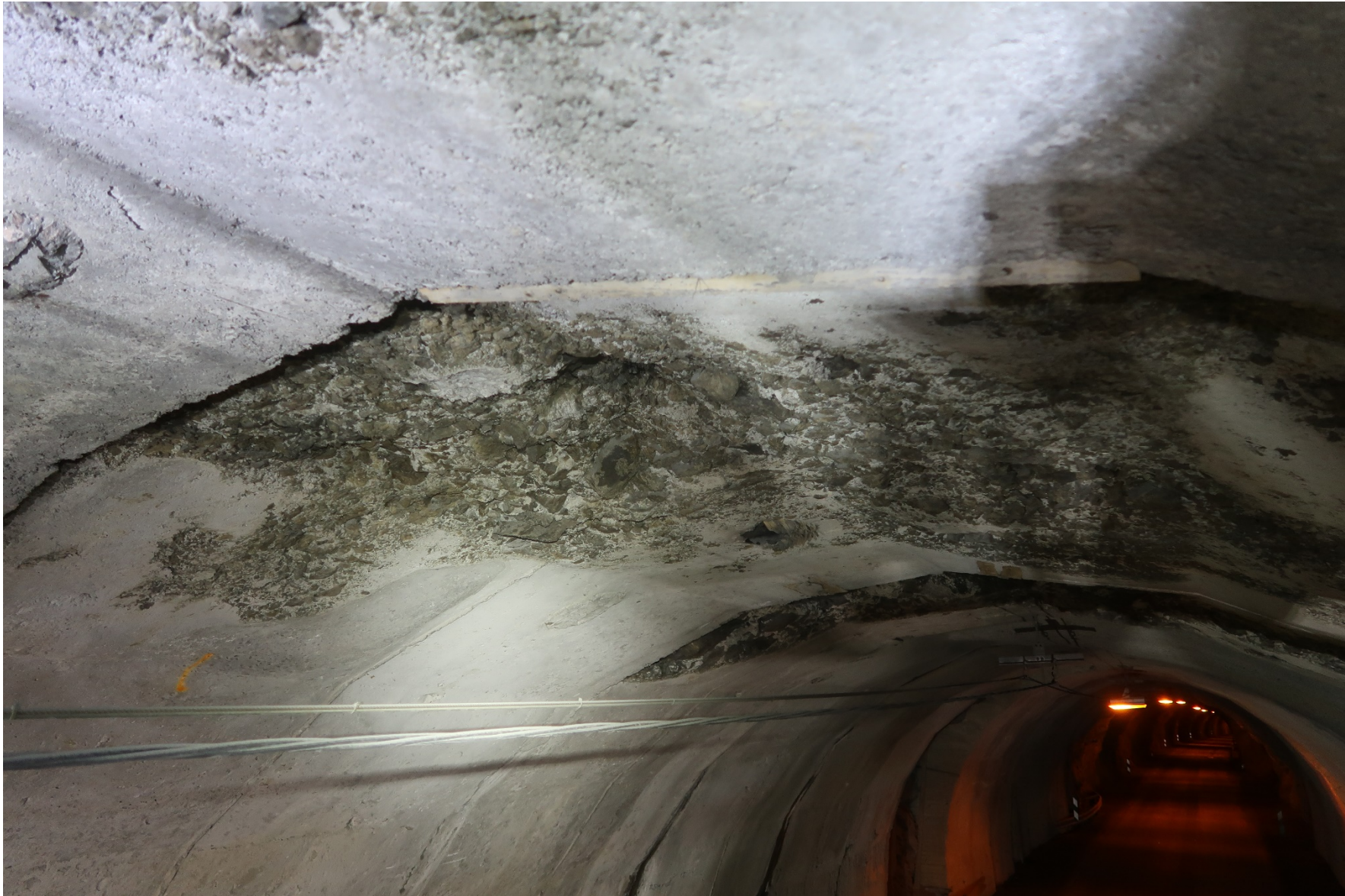
Figur 5. Bilde av steinreir i betongutstøping.
