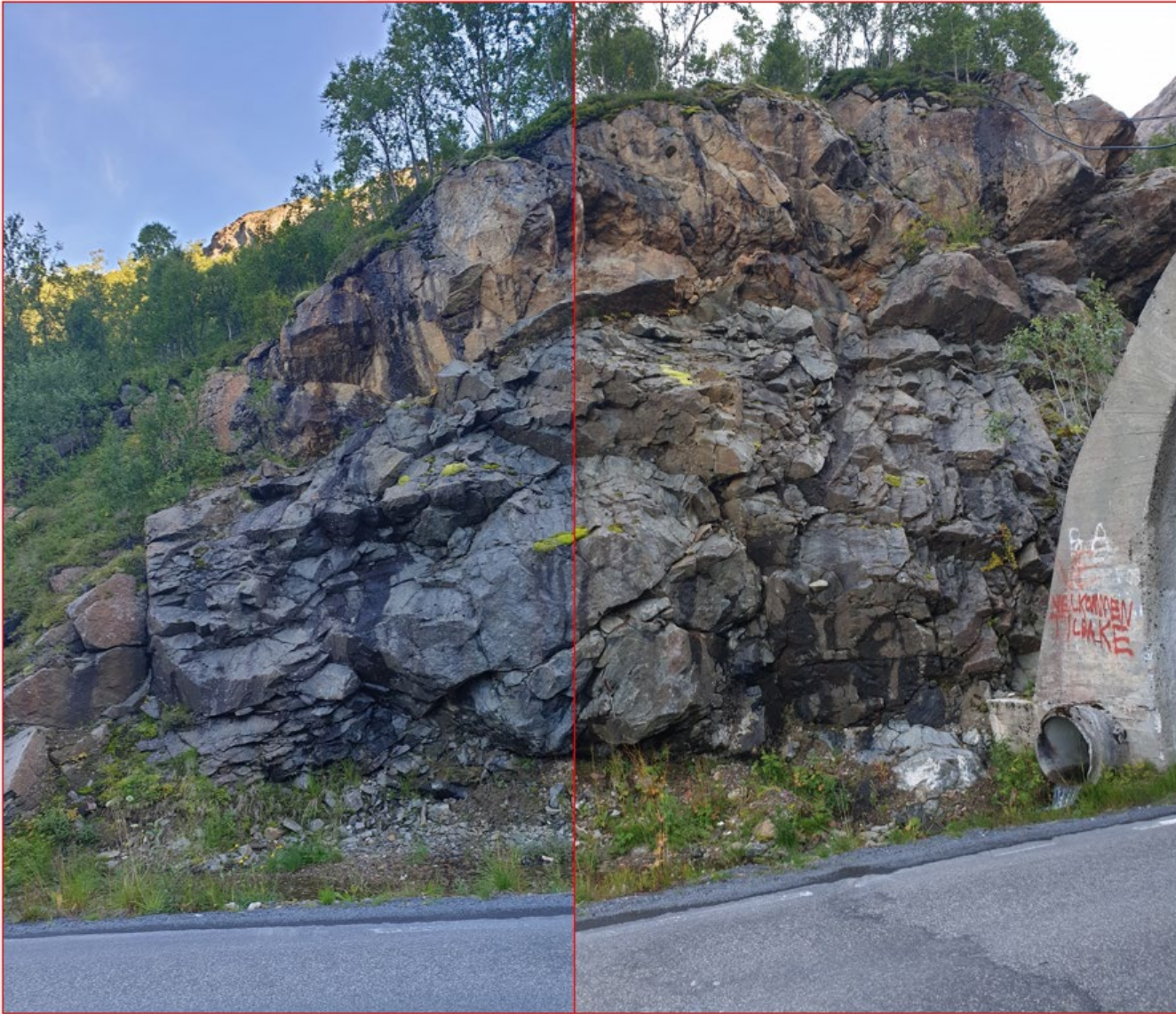
Figur 4. Vestre forskjæring. Det anbefales å montere forsterket steinsprangnett i denne bergskjæringen, dersom det skal foregå arbeider i dette området.
