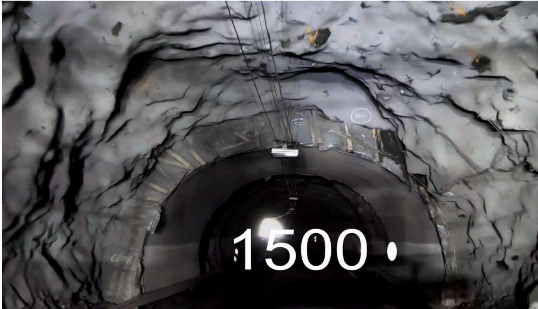
Figur 10. Platshelv fungerer som vann -og frostsikring, ved pel 1500.
