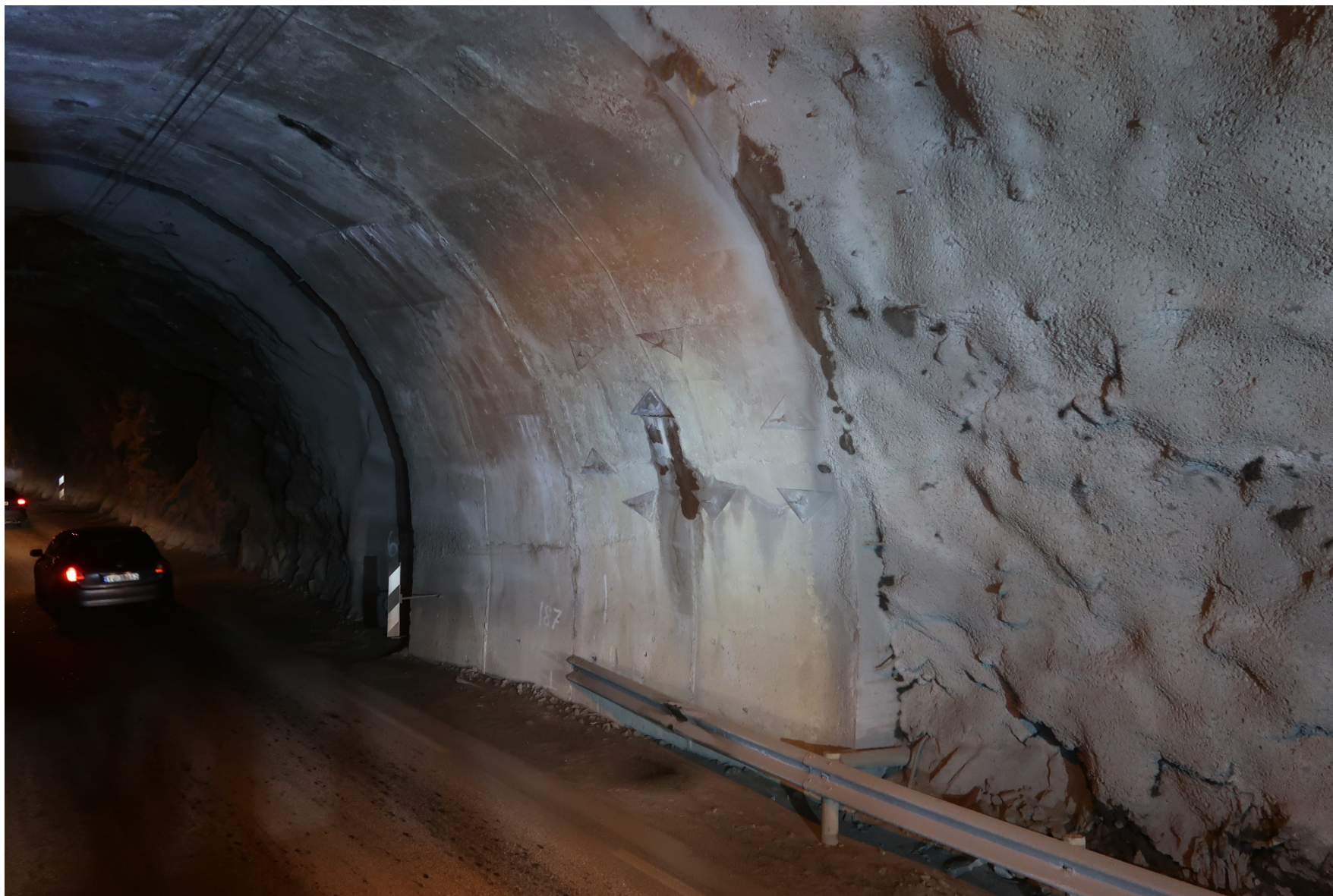
Figur 7. Delvis rustede bolter i betongutstøping ved pel 673-680.
