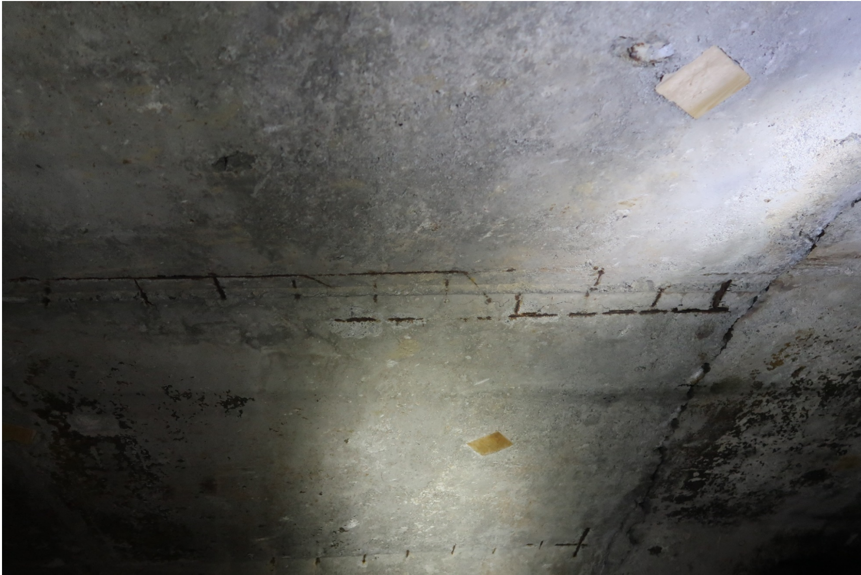
Figur 6. Rustet armering i betongutstøping.
