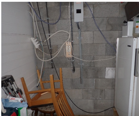
Figur 14 Vegger av betongstein i kjeller.
