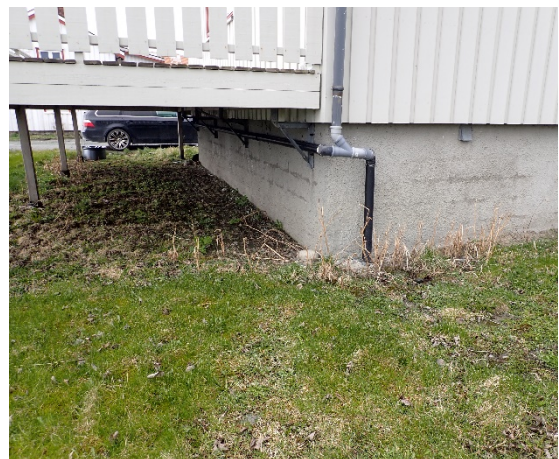
Figur 15 Puss på betongstein i grunnmur.
