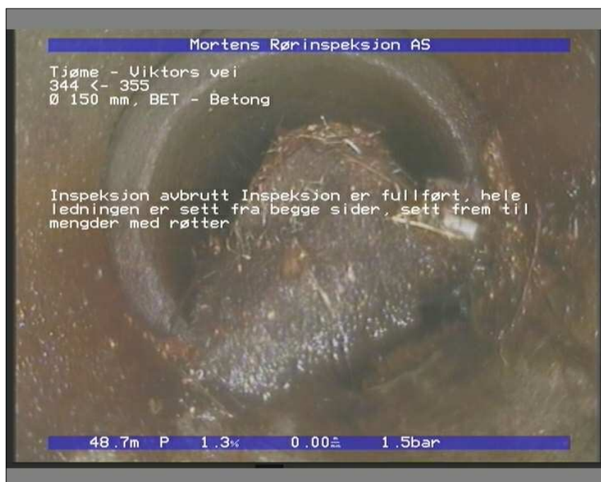
Foto: 2_1_S_Sectionname_21082019_093056_B_OV_BET_150_IA.JPG 48,72m, Inspeksjon avbrutt Hindring, røtter
