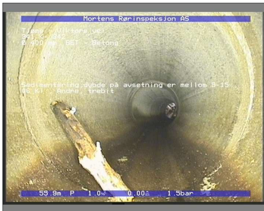
Foto: 8_1_S_Sectionname_21082019_104750_B_OV_BET_400_SM2.JPG 55,95m, Sedimentering,dybde på avsetning er mellom 5-15%, 06 Kl., Andre, trebit
