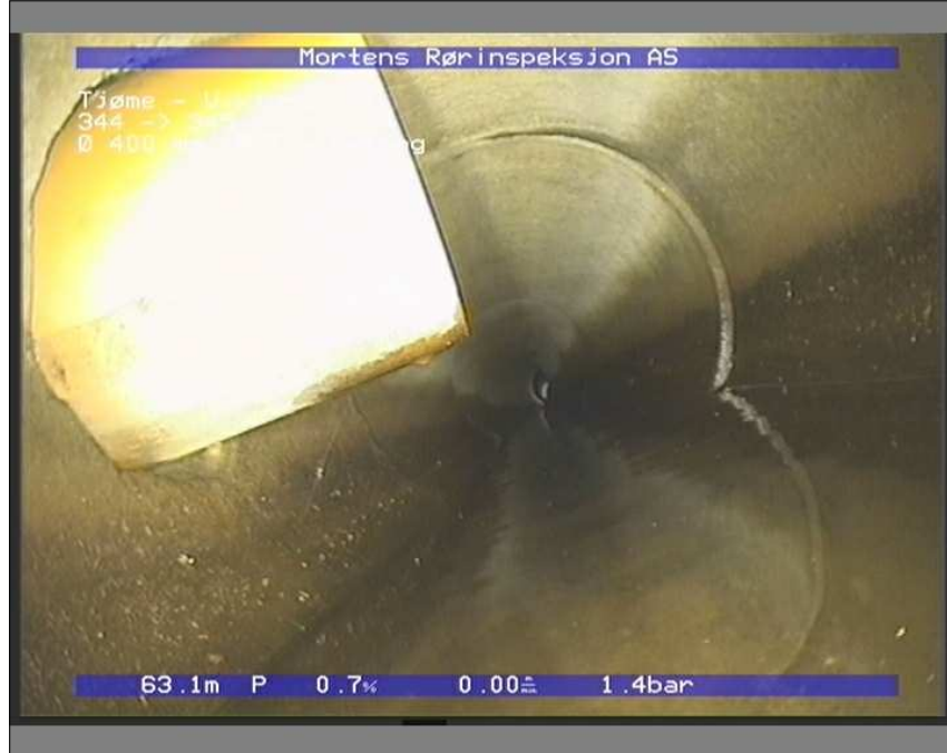
Foto: 5_1_S_Seccionname_21082019_095200_B_OV_BET_400_IR4.JPG 63,14m, Innstukket rør, Innstikk reduserer tverrsnittsarealet med mer enn 30 %, 10 Kl.
