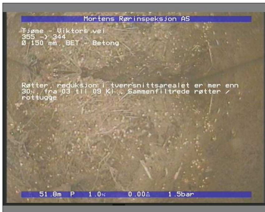
Foto: 1_1_S_Sectionname_21082019_084213_B_OV_BET_150_RØ4.JPG 51,84m, Røtter, reduksjon i tverrsnittsarealet er mer enn 30%, fra 03 til 09 Kl., Sammenfiltrede røtter / rottugge
