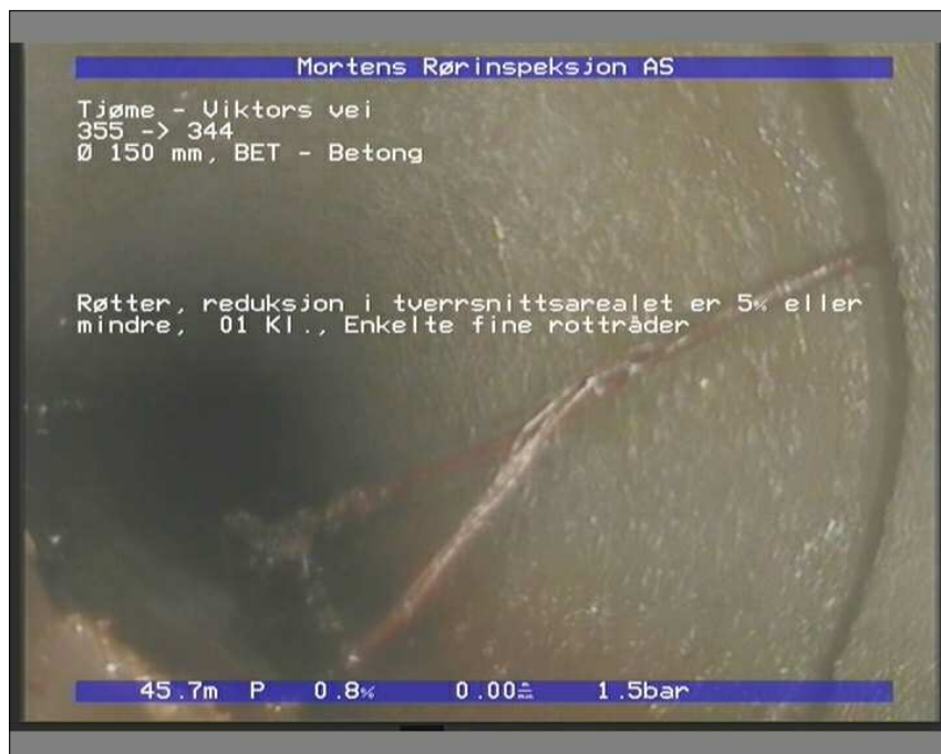
Foto: 1_1_S_Sectionname_21082019_084047_B_OV_BET_150_RØ1.JPG 45,77m, Røtter, reduksjon i tverrsnittsarealet er 5% eller mindre, 01 Kl., Enkelte fine rottråder
