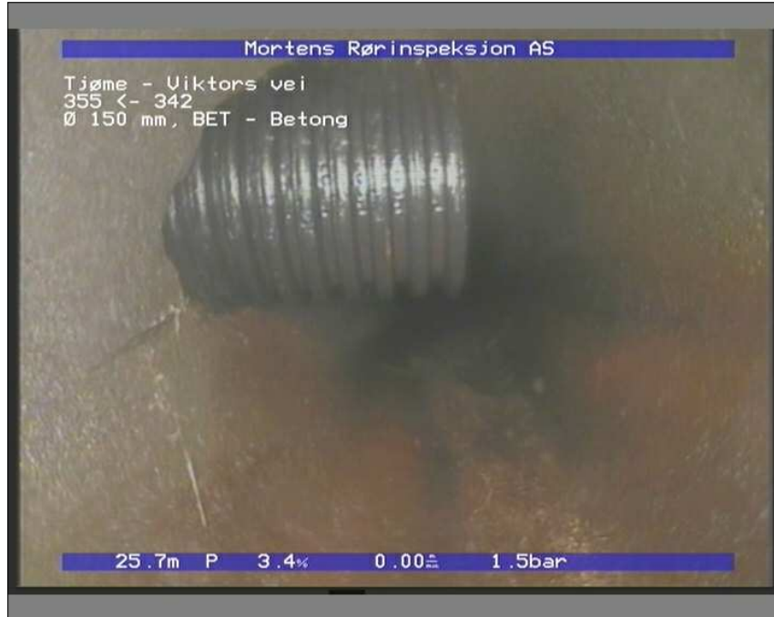
Foto: 3_1_S_Sectionname_21082019_085815_B_OV_BET_150_IR4.JPG 25,77m, Innstukket rør, Innstikk reduserer tverrsnittetsarealet med mer enn 30 %, 10 Kl.
