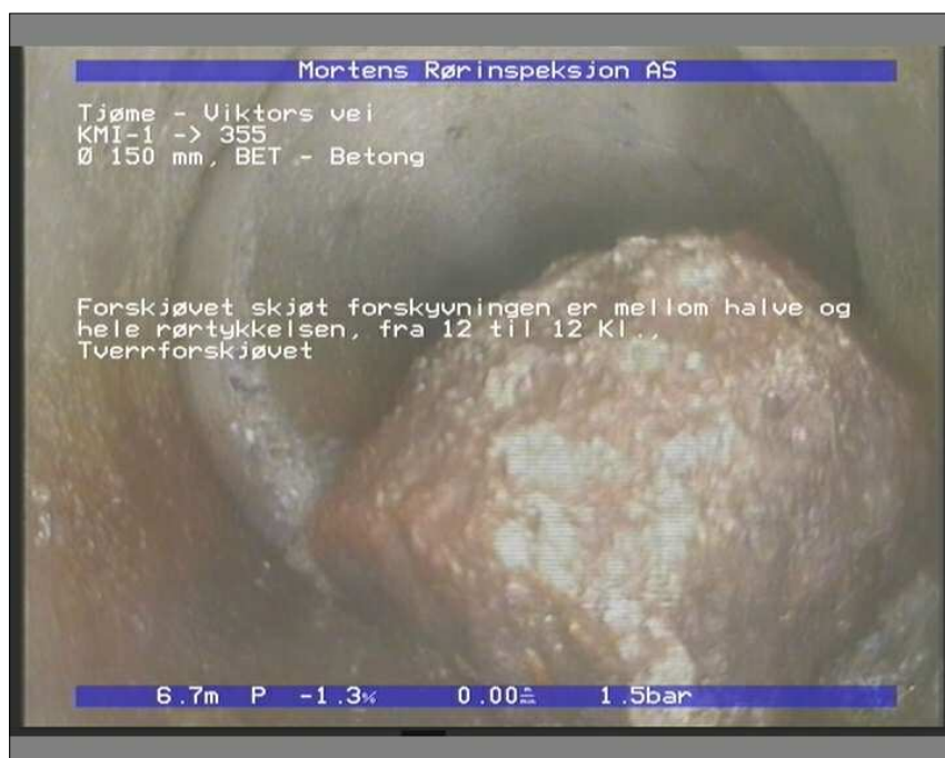
Foto: 4_1_S_Sectionname_21082019_091452_B_OV_BET_150_FS2.JPG 6,76m, Forskjøvet skjøt forskyvningen er mellom halve og hele rørtykkelsen, fra 12 til 12 Kl., Tverrforskjøvet
