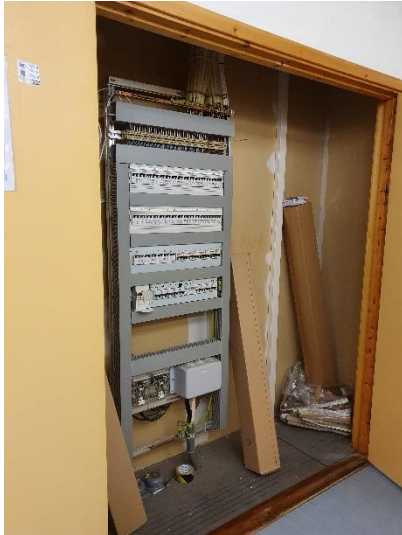
EL-tavle i Blokk A, veggtilsvarende i Blokk B
