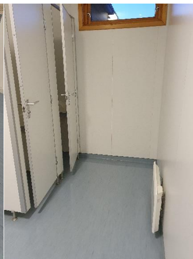
Panelovn på toalettrom.
