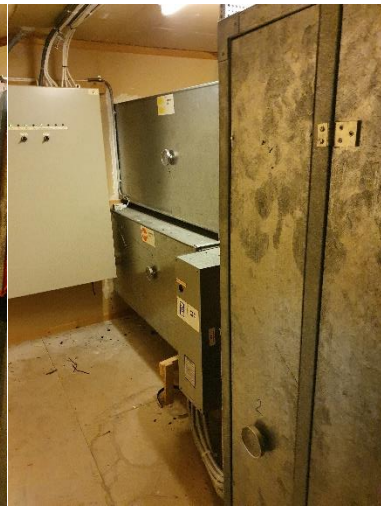
Ventilasjonsanlegg Blokk A
