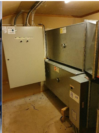
Ventilasjonsanlegg Blokk A
