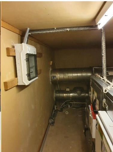
Ventilasjon Blokk B
