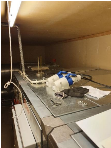
Ventilasjon, Blokk B
