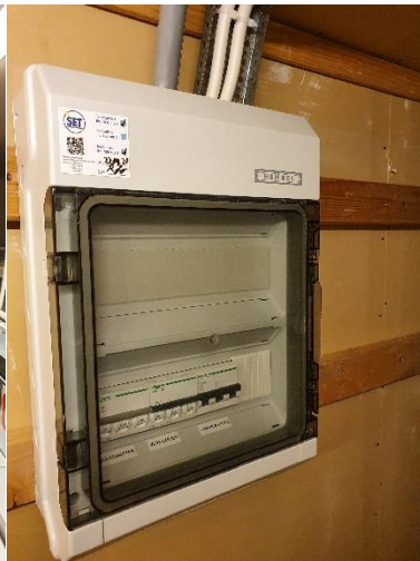
Ventilasjon – skap, Blokk B
