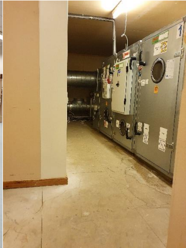
Ventilasjonsaggregat Blokk B
