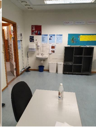
Sanitærutstyr, typisk klasserom
