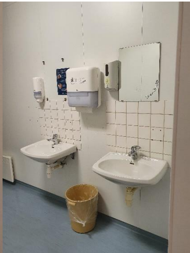
Sanitær i toalettrom
