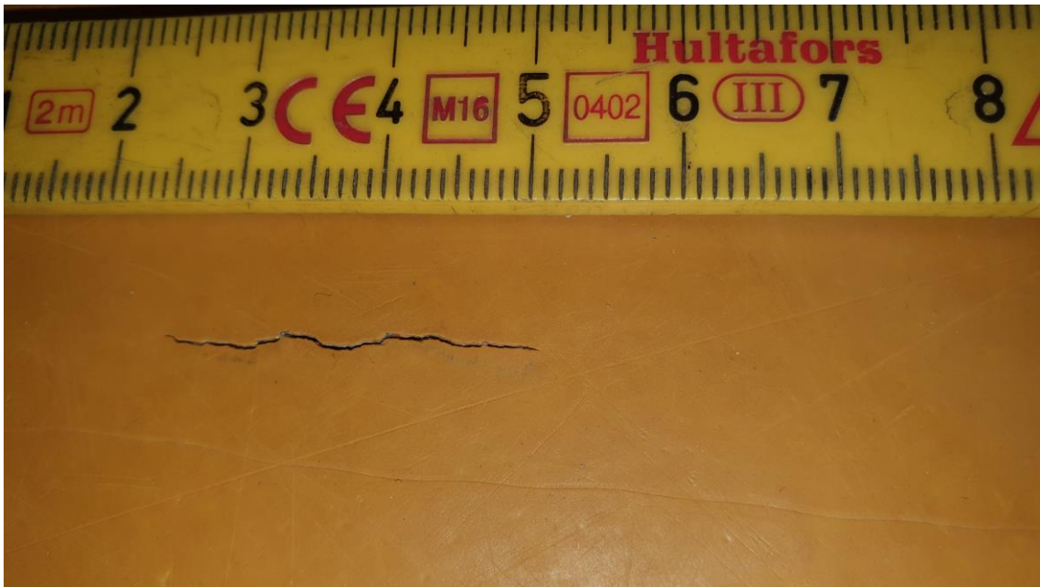
Bilde nr. 4: Oppsprekking i toppbelegget
