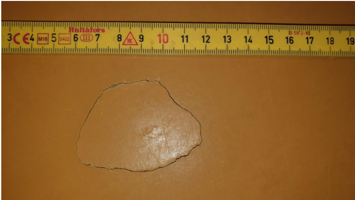
Bilde nr. 5: Skade / oppsprekking i toppbelegget
