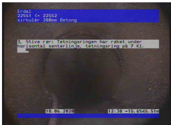
L_22551_22552__16.jpg, 00:06:44, 45.51m 3, Stive rør: Tetningsringen har røket under horisontal senterlinje, tetningsring på 7 Kl.
