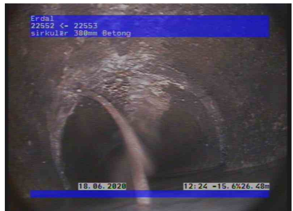
L_22552_22553__13.jpg, 00:05:21, 26.48m 2, Stive rør: Tetningsringen har røket over horisontal senterlinje, tetningsring på 10 Kl.
