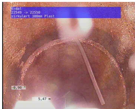
L_22549_22550_260620_091429_3.jpg, 00:02:02, 5.47m Synlig pakning,, pakningsringen har røket, av 12 Kl. til 4 Kl.
