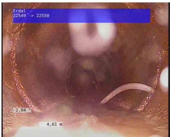
L_22549_22550_260620_091429_2.jpg, 00:01:38, 4.60m Synlig pakning,, pakningsringen har røket, av 4 Kl. til 6 Kl.
