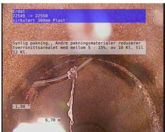
L_22549_22550_260620_091429_4.jpg, 00:02:27, 6.70m Synlig pakning,, Andre pakningsmaterialer reduserer tverrsnittetsarealet med mellom 5 - 15%. av 10 Kl. til 12 Kl.
