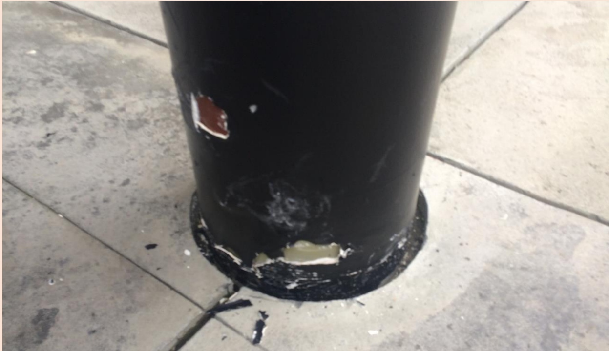
Bilde viser parti nede ved dekke. Nedbrutt brannbeskyttelse. Brannmalingen er helt nedbrutt og løsner fra primer / mellomstrøk.
