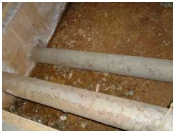
Bilde 6: Avløpsrester i bassengkanal.
