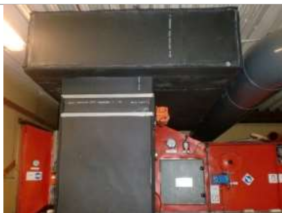
Bilde 19: Cellegummi i ventilasjonsanlegg.
