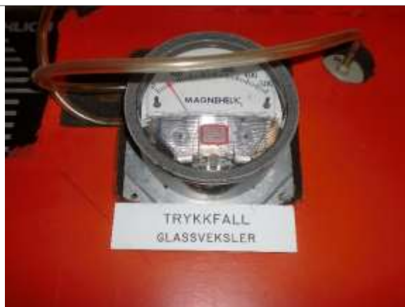
Bilde 16: Trykkmåler observert i kartlagt bygningen.
