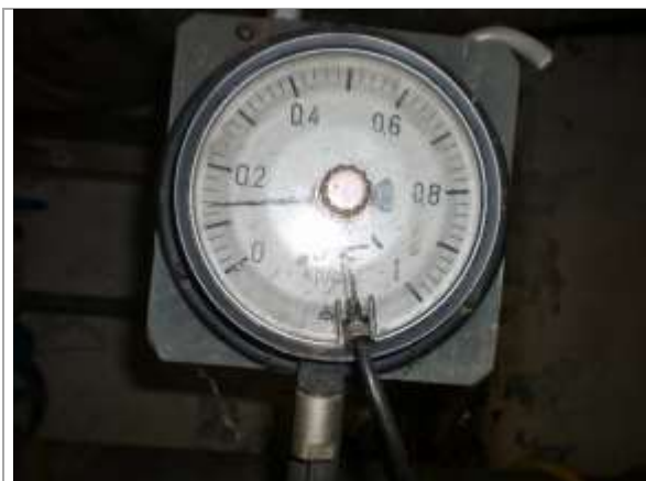
Bilde 15: Trykkmåler observert i kartlagt bygningen.
