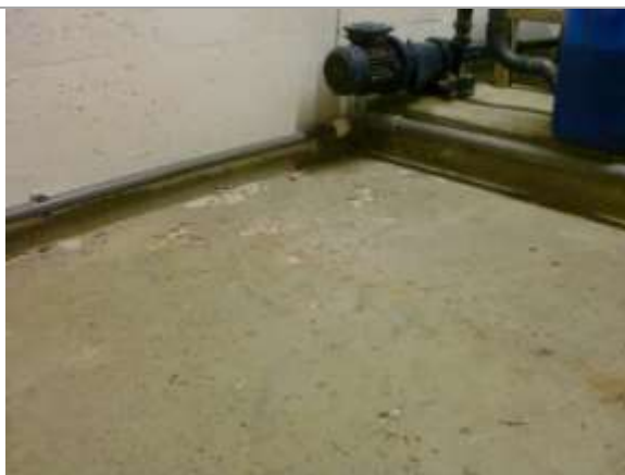
Bilde 8: Epoxy/maling på betong gulv.
