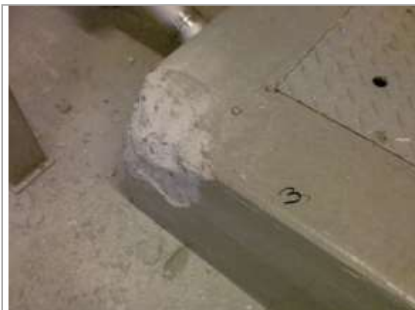
Bilde 7: Betong uten maling/epoxy.
