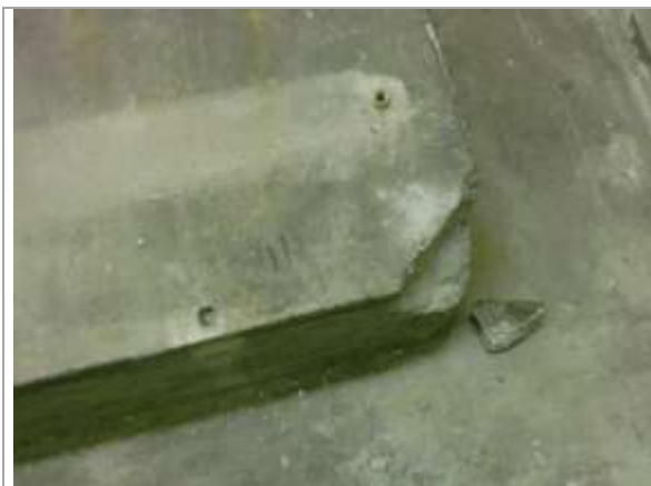
Bilde 13: Betongprøve fra dekke, kompressorrom.
