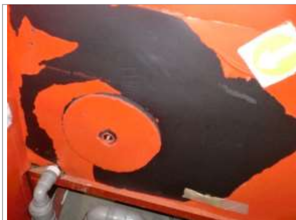
Bilde 18: Cellegummi i ventilasjonsanlegg.
