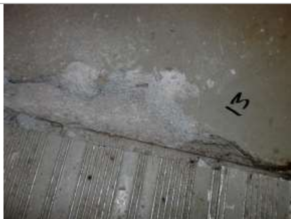
Bilde 14: Betongprøve fra bassengoverflate, 1.etg.
