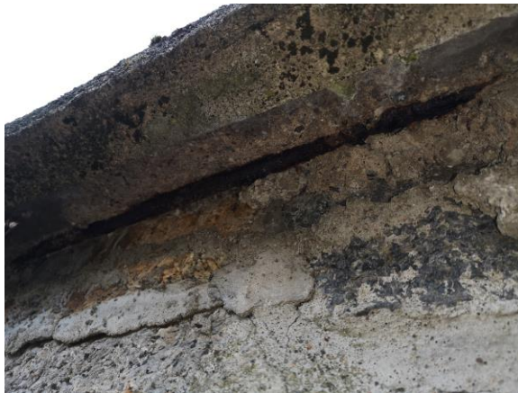
7: Underkant av dekke med dryppnese og synlig armering
