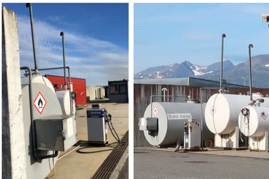
Figur 2-3: Dieseltank (6000l) på eksisterende plassering
