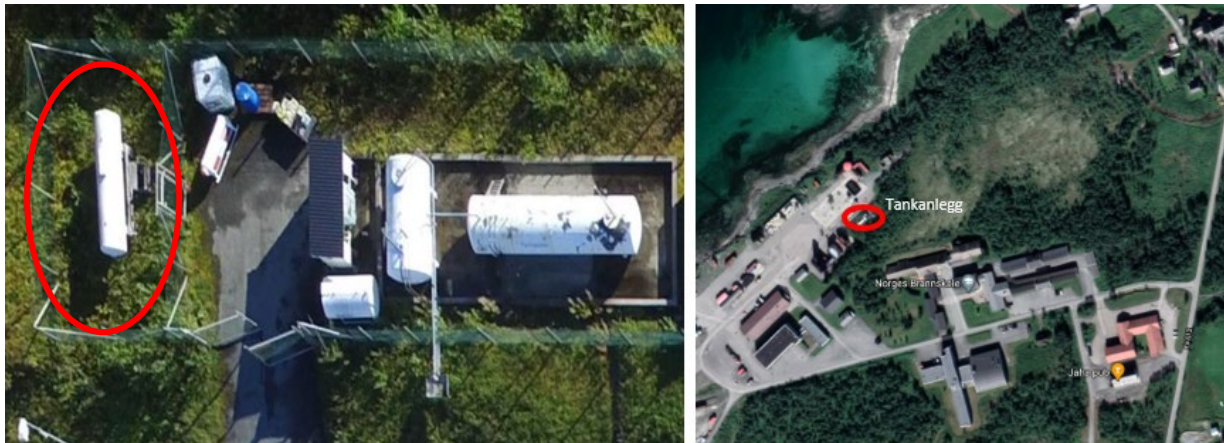
Figur 2-5: Tankanlegg til venstre (Propantank i inngjerdet område t.v.). Plassering av tankanlegg i området er vist til høyre
