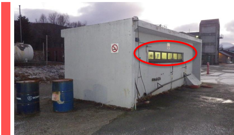
Figur 6-1 Isolerglassvinduer med antatt innhold av klorparafiner i Bygg 61a, markert med rød sirkel.
