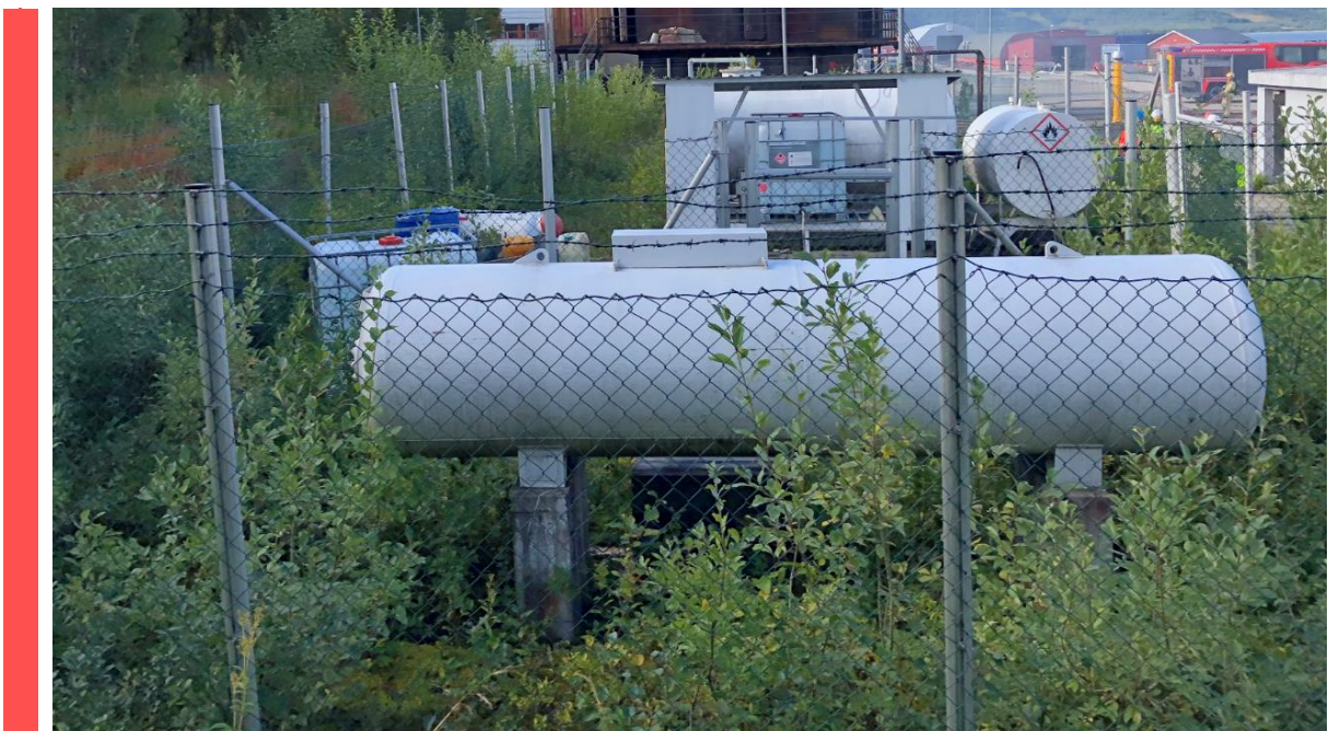
Figur 6-19 Propantank i stål på betongfundament.
