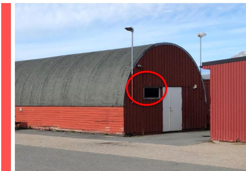
Figur 6-2 Isolerglassvinduer med mistenkt innhold av klorparafiner i Bygg 35, markert med rød sirkel.
