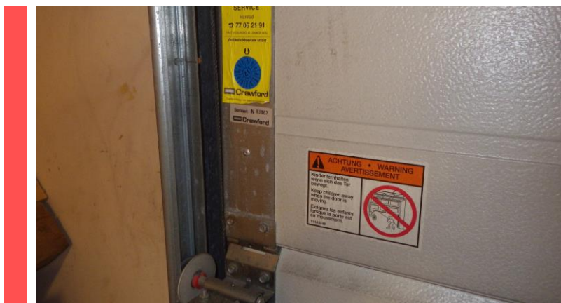
Figur 6-16 Leddport i Bygg 35.
