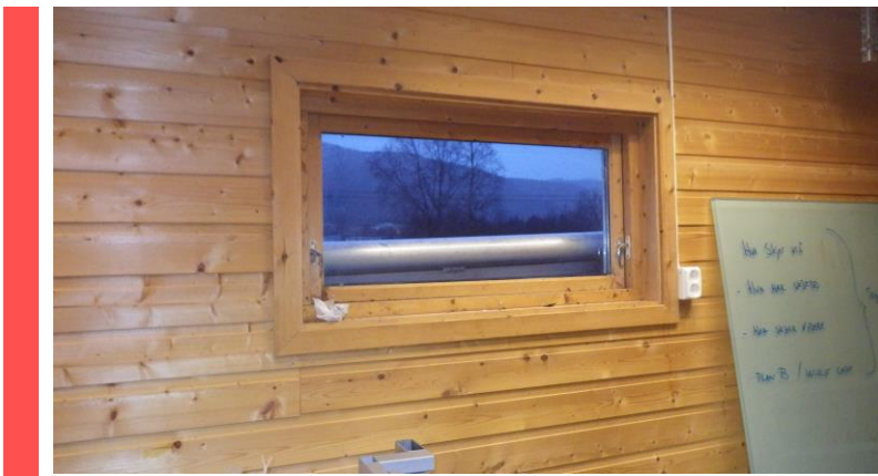
Figur 6-4 Umerket isolerglassvindu med mistenkt innhold av PCB i ski- og sykkelboden i Bygg 7.
