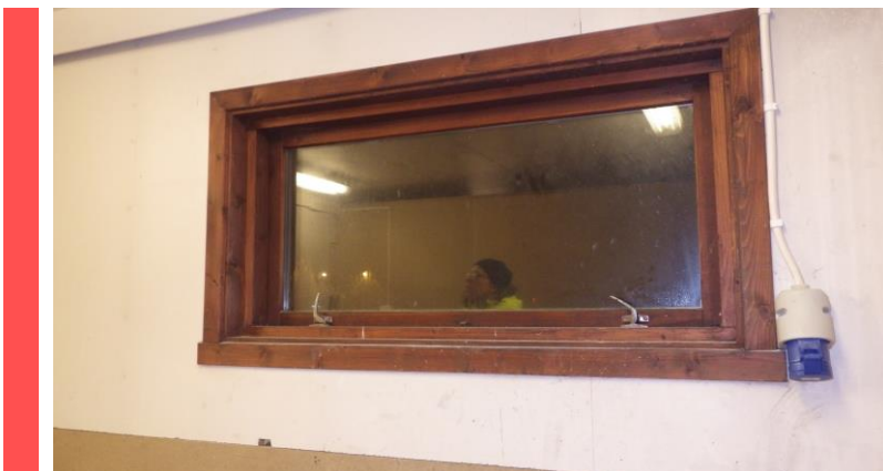
Figur 6-6 4 stk. isolerglassvindu med mistenkt innhold av PCB i Bygg 36.
