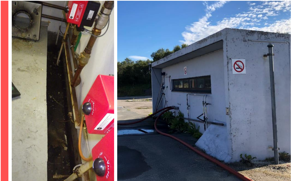
Figur 6-18 Rester av olje i rennen og rør i Bygg 61a (bildet til venstre). Bildet til høyre viser rør på utsiden av Bygg 61a. Det antas være olje eller rester av olje i rørene.
