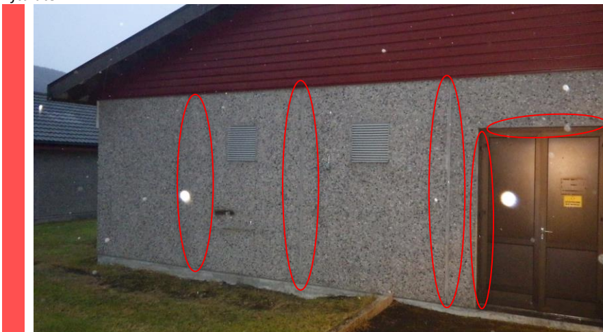
Figur 6-15 Bygg 9, myk fugemasse mellom betongelementer og rundt dør. Ikke påvist PCB, men vurderes som farlig avfall mht. ftalater.
