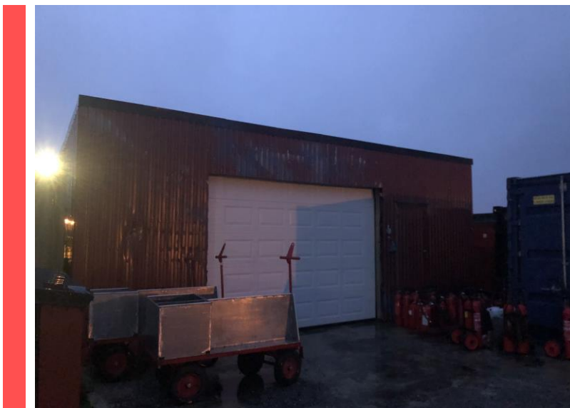
Figur 6-17 Leddport i Bygg 36.
