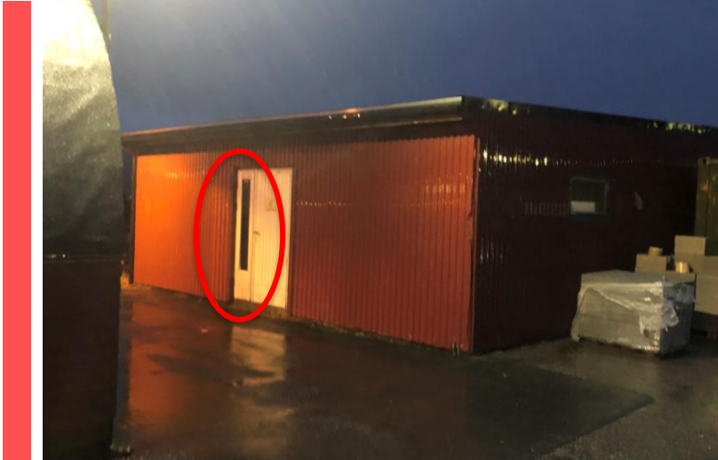
Figur 6-3 Isolerglassvinduer med mistenkt innhold av klorparafiner i Bygg 36, markert med rød sirkel.
