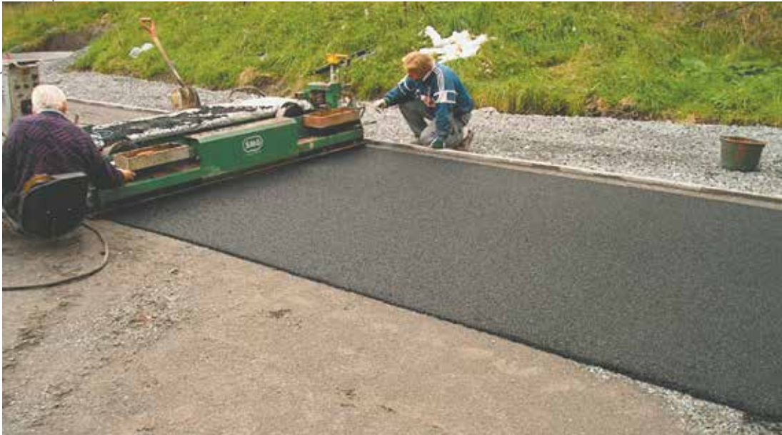
Utlekking av plaststøpt støtdempingssjikt (pad)
