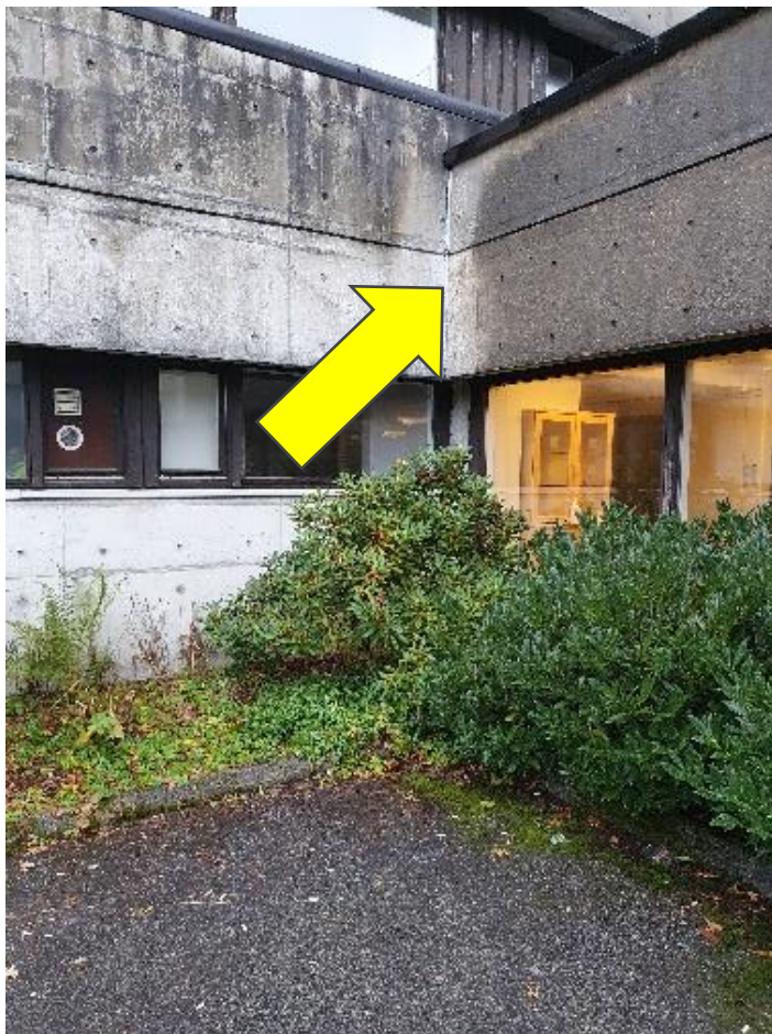
Figur 3 Fuge mellom betongelementer inneholder både asbest og PCB
