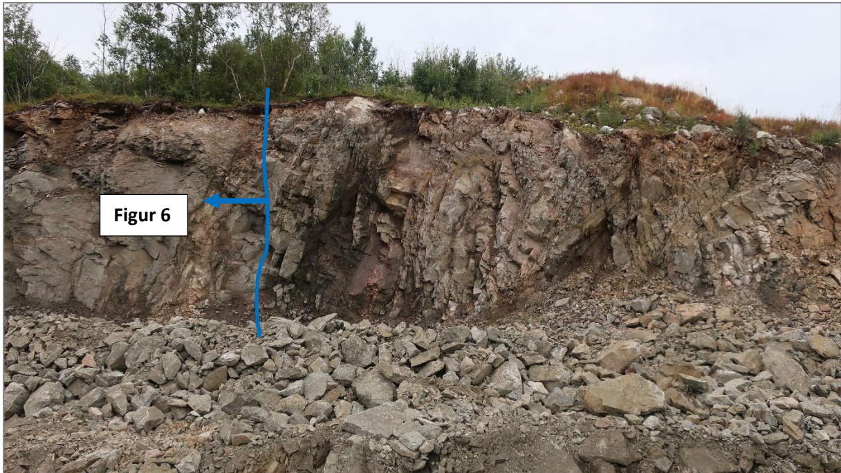
Figur 7: Eksisterende skjæring, sett mot sør. Skjæringen er preget av oksidasjon og sterk oppsprekking langs steilt sprekkesett.
