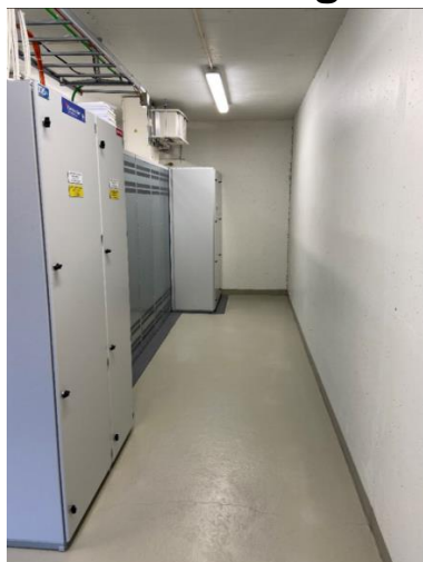
Figur 10 – hovedtavlerom bygg 5 avd. Mandal. (Er identisk på avd. Froland).
