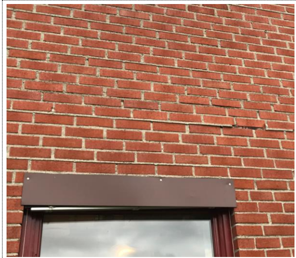
Bilde nr. RIB 32 Utsprengte fuger på grunn av korrodert forsterkning av stål over vindu.
