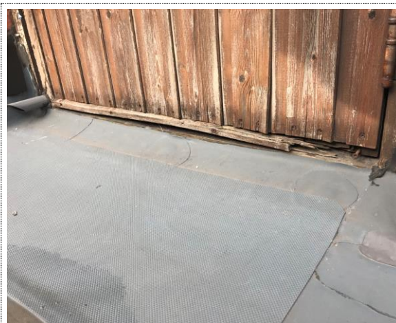
Bilde nr. RIB 10 Eldre tredør går i oppløsning på grunn av fuktskader over tid. Døren mangler vedlikehold slik at vannet trekker inn i treverket. Deler av terskel er borte på grunn av råte, og dermed fri tilgang til avslutning på membran.
