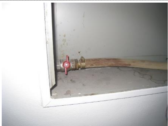
Bilde nr. RIV 17 Stengekran i brannskap svært hard, skiftes
