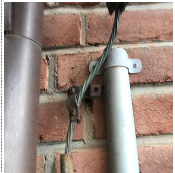
Bilde nr. RIE 12 Lynvern: Nedleder feste har løsnet.
