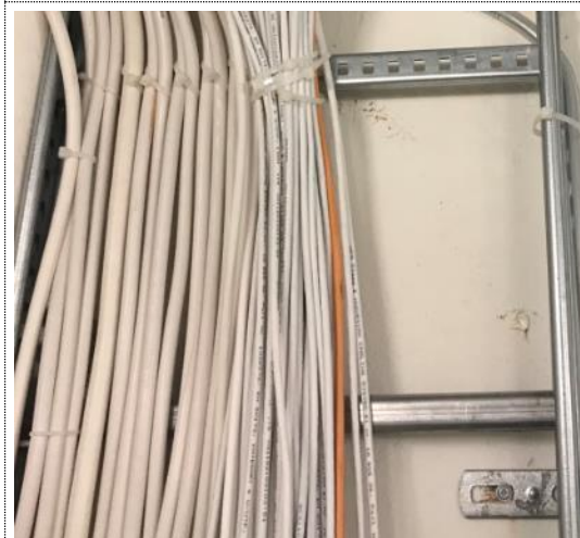
Bilde nr. RIE-04 Kraftkabler og svakstrømskabler har ikke nok avstand.
