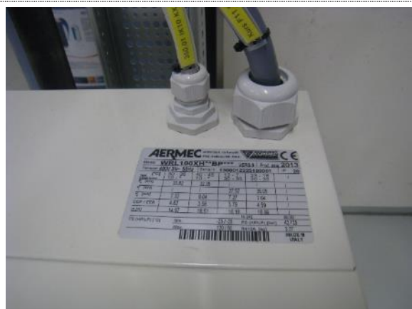
Bilde nr. RIV 43 Varmepumpe for varme til avlastningsbygg.
