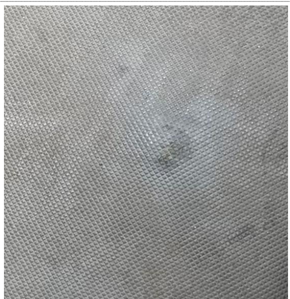
Bilde nr. RIB 11 Membran på værplatået hvor underliggende skruer er presset nesten gjennom membranen.
