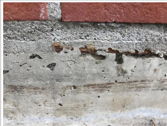
Bilde nr. RIB 36 Nærbilde av korrodert armering vist på bildet ved siden av.
