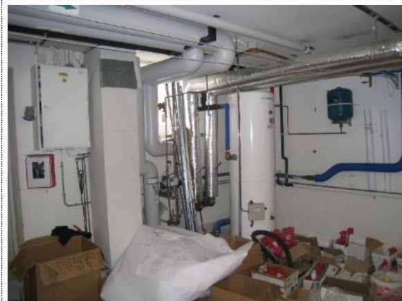
Bilde nr. RIV 32 Varmtvann kan ettervarmes i bereder
