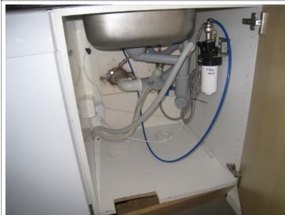
Bilde nr. RIV 18 Cu rør delvs innmurt, Skap skadet
