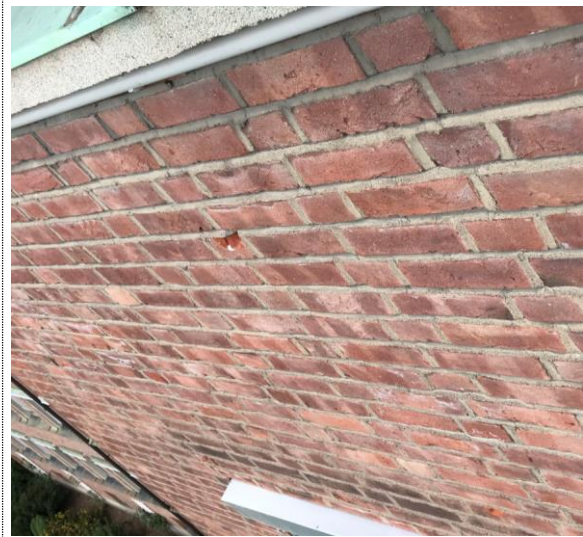
Bilde nr. RIB 06 Avskallet hjørne på teglstein, trolig forårsaket av frost. Eldre teglstein kan ha redusert eller manglende frostmotstandsevne.
