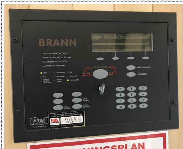
Bilde nr: RIE 20 Brannalarmsentral
