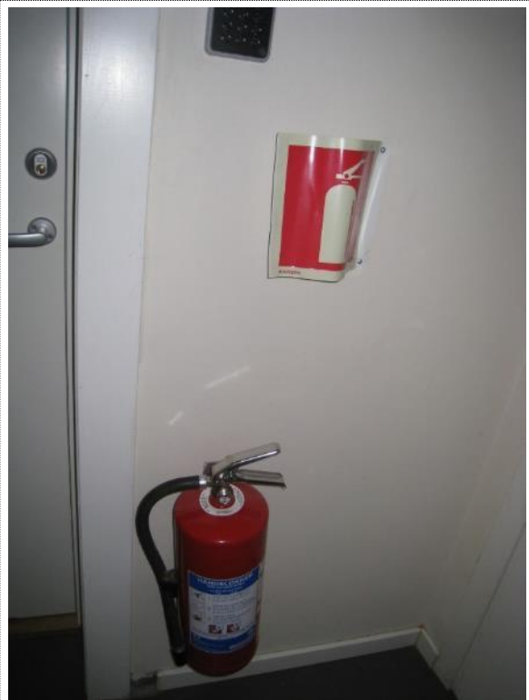
Bilde nr. RIV 23 Skilt for brannapparat skadet.
