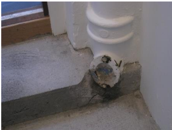
Bilde nr. RIV 01 Rust og begynnende lekkasje i opplegg
