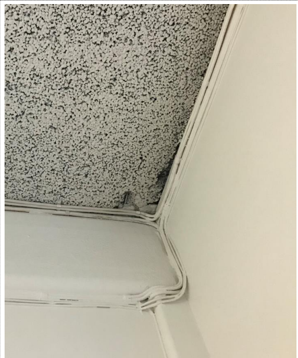
Bilde nr. RIB 27 Synlig armering i underkant av lettklinker elementer som er brukt som etasjeskiller i avlastningsbygget.
