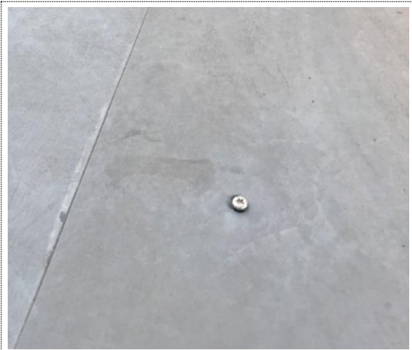
Bilde nr. RIB 13 Skrue som punkterer membranen. Skruen har trolig blitt skrudd ned etter at taket ble teknet.
