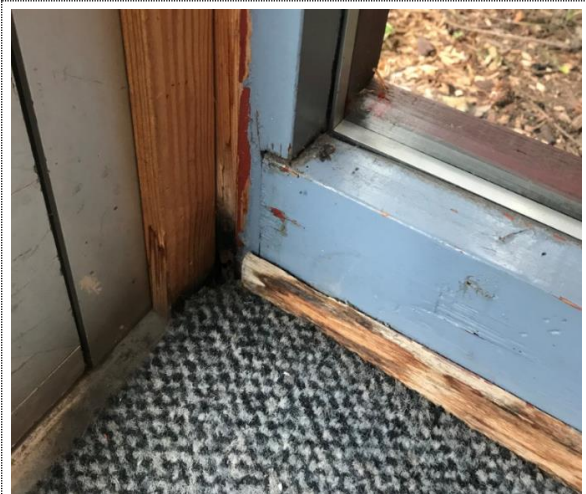
Bilde nr. RIB 25 Tydelig fuktskader langs gulv i vindfang.
