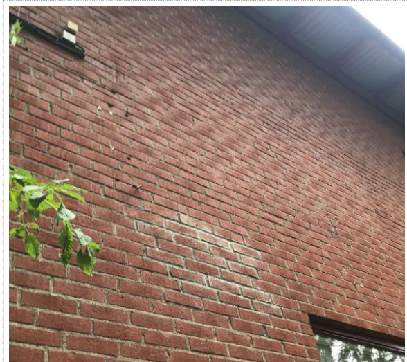
Bilde nr. RIB 34 Peforete fuger og steiner. Felt med utskiftede tegl og rester av silikonfuger på fasade. Utstikkende armering eller bolt fra et av hullene.
