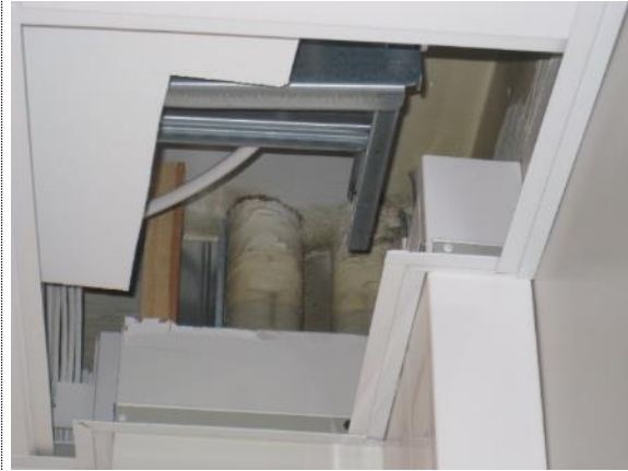
Bilde nr. RIV 12 Gamle varmerør er ikke skiftet
