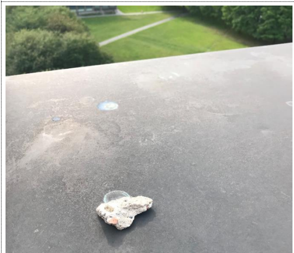
Bilde nr. RIB 04 Betongbit fra murkrone som ligger på beslag rundt værplatået. Det er over 6 etasjer ned til fortauet på nedsiden.
