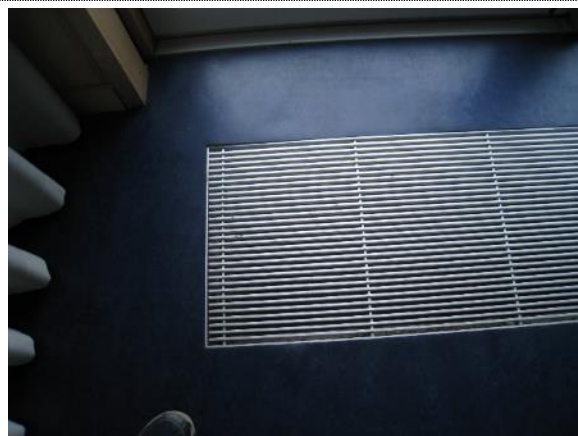
Bilde nr. RIV 39 Brønn for konvektor
