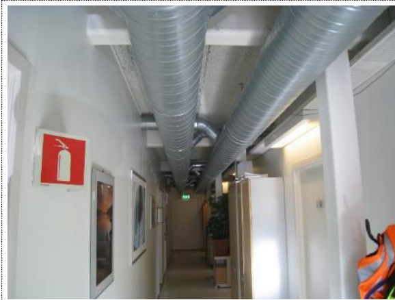
Bilde nr. RIV 48 Kanalføring i korridor
