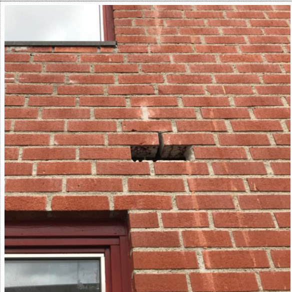
Bilde nr. RIB 29 Manglende teglstein i fasade mot nord.
