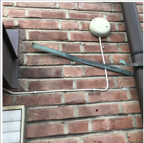
Bilde nr. RIE-05 Lynvern: Utjevning har løsnet.
