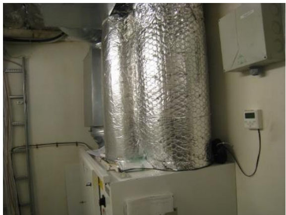
Bilde nr. RIV 15 Aggregat for del av 4 etg
