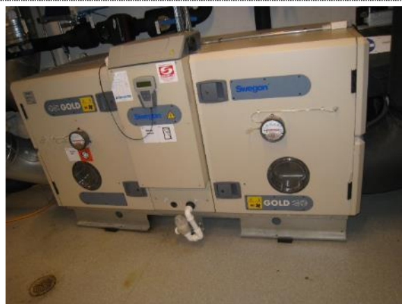
Bilde nr. RIV 41 Aggregat for kantinekjøkken
