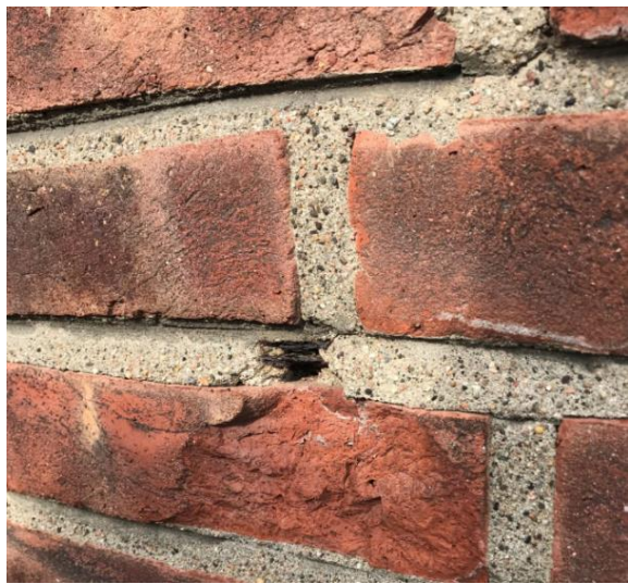
Bilde nr. RIB 05 Korrodert armering i fuge. Mørtelen er «sprengt bort» som følge av armeringskorrosjonen.
