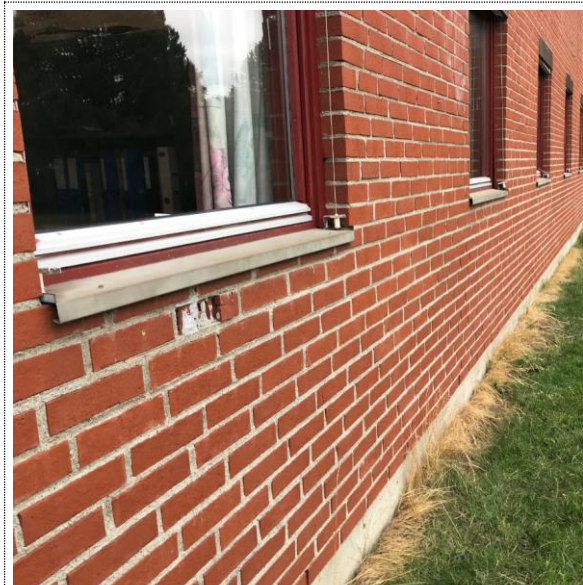
Bilde nr. RIB 30 Teglstein med avskallet overflate under vindu.
