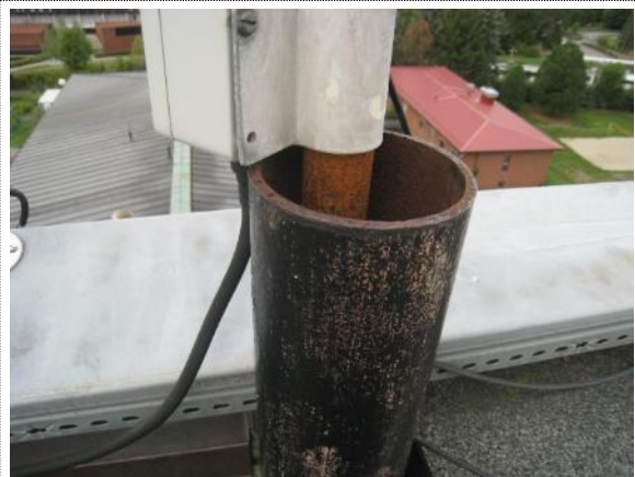
Bilde nr. RIV 06A Antenne plassert i lufting for Spillvann
