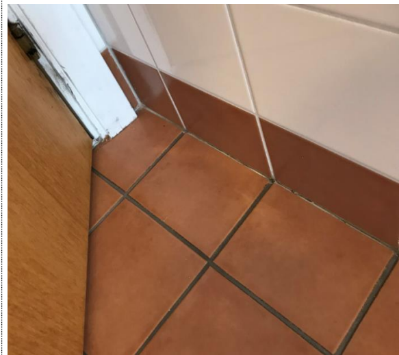
Bilde nr. RIB 16 Sprukket fug i overgang gulv og vegg.
