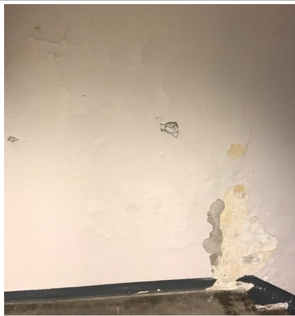
Bilde nr. RIB 17 Salt- og/eller kalkutslag på yttervegg i trapperom ned til kjeller.
