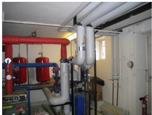
Bilde nr. RIV 31 Fjernvarmeveksler
