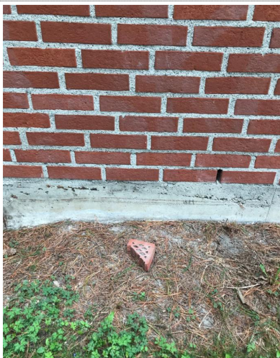
Bilde nr. RIB 37 Armeringskorrosjon og knekt teglstein.
