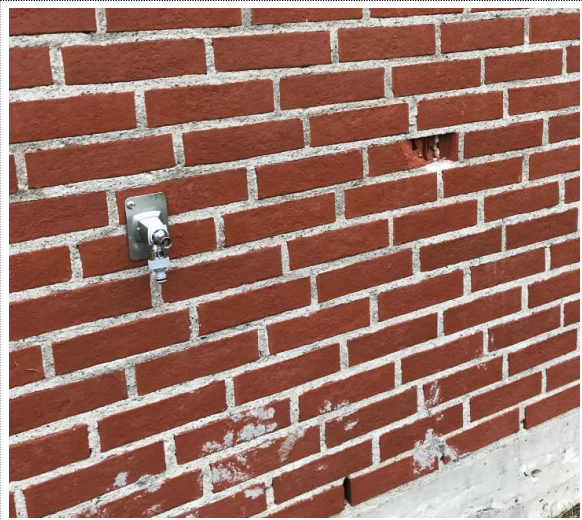
Bilde nr. RIB 31 Ødelagt stein i fasade trolig forårsaket av frost.
