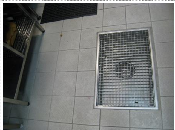
Bilde nr. RIV 38 Slukbrønn kjøkken tilkoblet fettutskiller?
