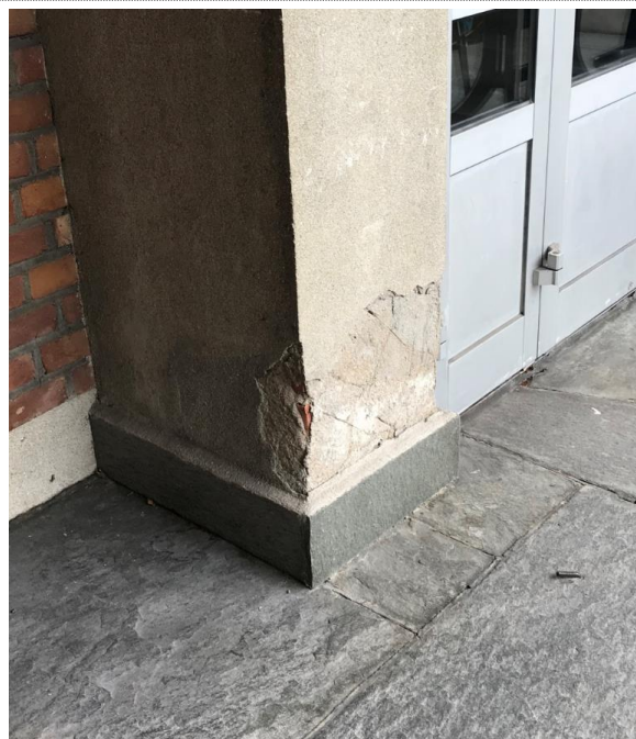
Bilde nr. RIB 19 Skadet puss på veggliv ved inngangsdør på byggets sydside.
