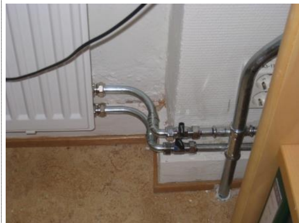
Bilde nr. RIV 26 Avstengingskraner på radiatorer kan bli et lekkasje problem.
