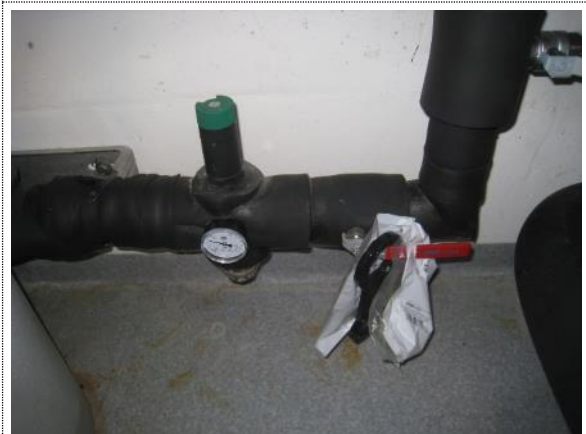
Bilde nr. RIV 44 Vanninnlegg. Stengekraner OK
