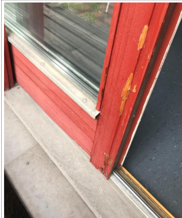
Bilde nr. RIB 28 Uttøket skyvedør med oppsprukket og eksponert treverk. Områder av treverket viser tegn til oppsug av vann.
