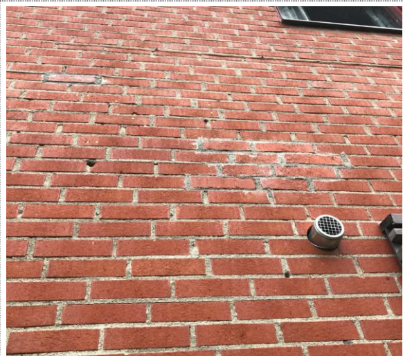
Bilde nr. RIB 33 Peforete fuger og steiner. Felt med utskiftede tegl og rester av silikonfuger på fasade. Gjennomføring i vegg er ikke tett.
