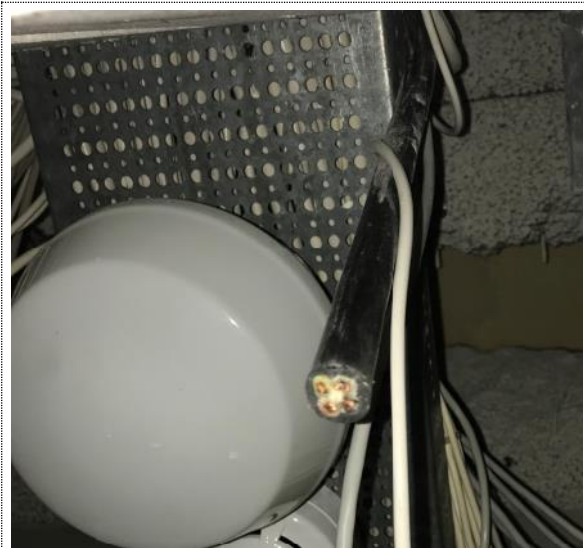
Bilde nr. RIE34 Kabler som er klippet uten å bli terminert i henhold til regelverk
