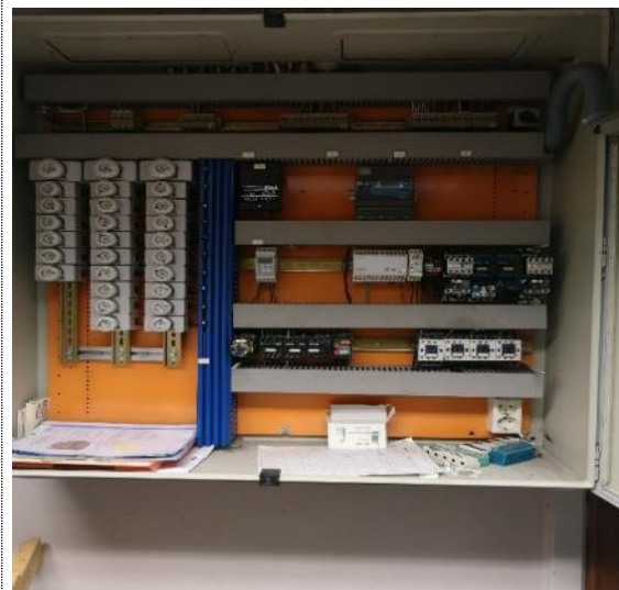
Bilde nr. RIE 07 Automatikk fordeling betjener avtrekksaggregat for verkstedet
