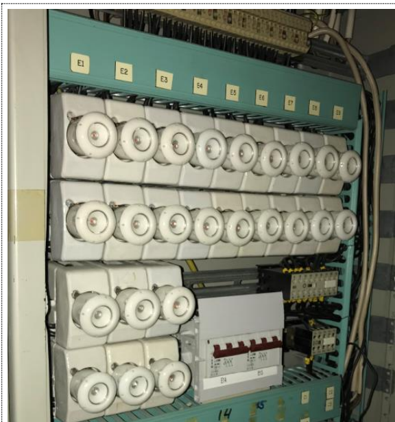
Bilde nr. RIE37 Underfordeling med gamle UZ elementer (skrusikringer)
