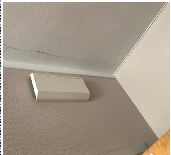
Bilde nr. RIB 15 Riss i tak i kontrolløy som brer seg ned i vegg.
