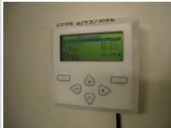
Bilde nr. RIV 16 Avleste verdier for aggregat del av 4 etg
