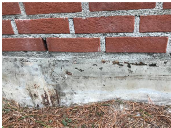
Bilde nr. RIB 35 Korrodert armering uten i overdekning i ringmur. Utstikkende kappede jern nede til venstre i bildet.
