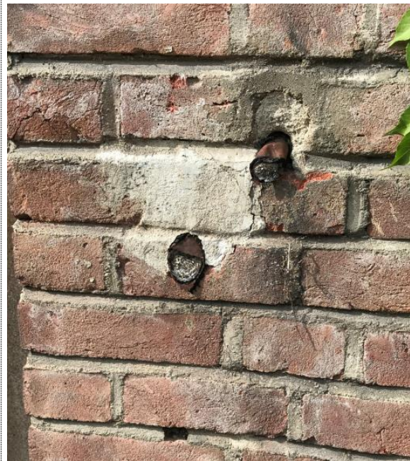
Bilde nr. RIE 16: Kabler som er klippet rett på utsiden av vegg.
