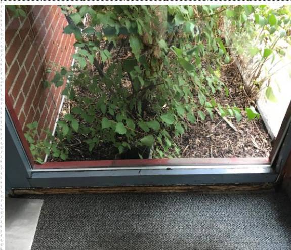
Bilde nr. RIB 26 I underkant av glassfelt er tydelig påvirket av fukt.
