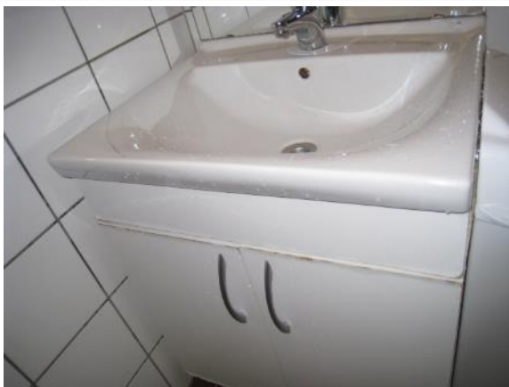
Bilde nr. RIV 21 Servantskap vannskadet
