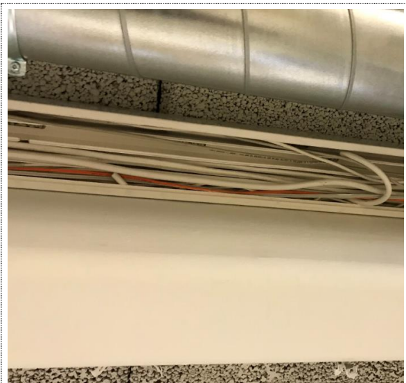
Bilde nr. RIE36 Kabelkanal som mangler lokk.
