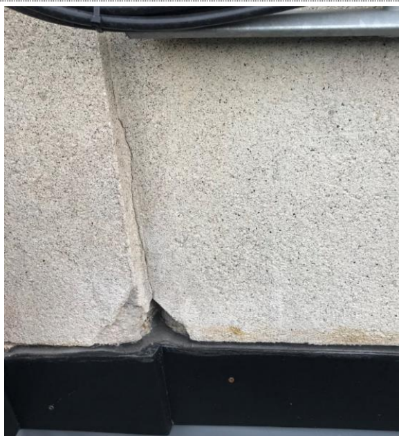
Bilde nr. RIB 07 Et nedre hjørne i betongen på værplataet er frostnedbryting på grunn av vanninnhold over kritisk nivå. Trolig kommet inn konstruksjonen pga. stående vann eller via småriss eller dårlig overganger.
