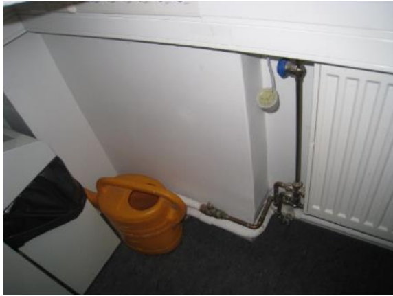
Bilde nr. RIV 11 Gamle varmerør er ikke skiftet
