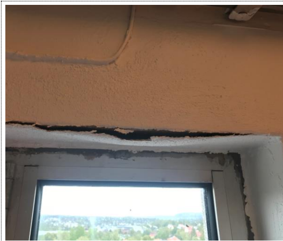
Bilde nr. RIB 14 Puss i overkant av vindu i tårnbygget har sluppet betongen.
