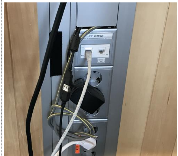
Bilde nr: RIE 21 Datakabel som ikke er terminert.
