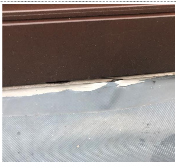
Bilde nr. RIB 09 Manglende tetting og nødvendig beslag i underkant av dør ut på værplatået. Dørterskel i tre er sprukket som følge av fukt og stående vann og snø kan renne rett inn i glipper til membranen.
