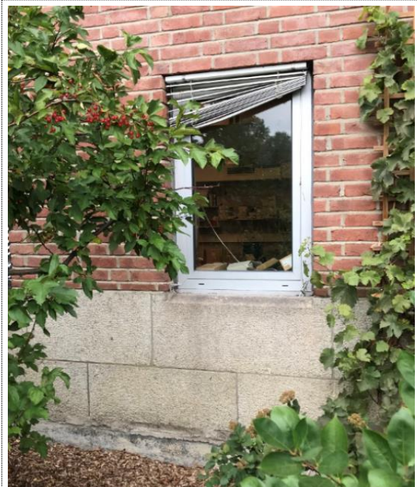
Bilde nr. RIB 20 Solavskjermingen har flere steder hengt seg fast eller har skadde lameller og skinner.
