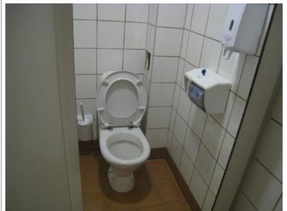
Bilde nr. RIV 22 Inspeksjonsluke mangler
