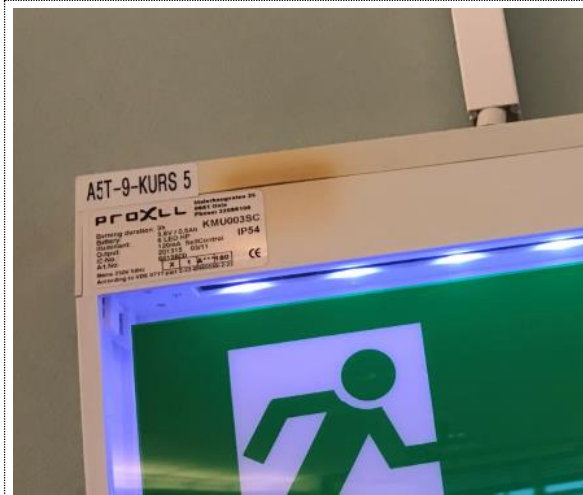
Bilde nr: RIE-06 Tydelig misfarging etter varmeutvikling.
