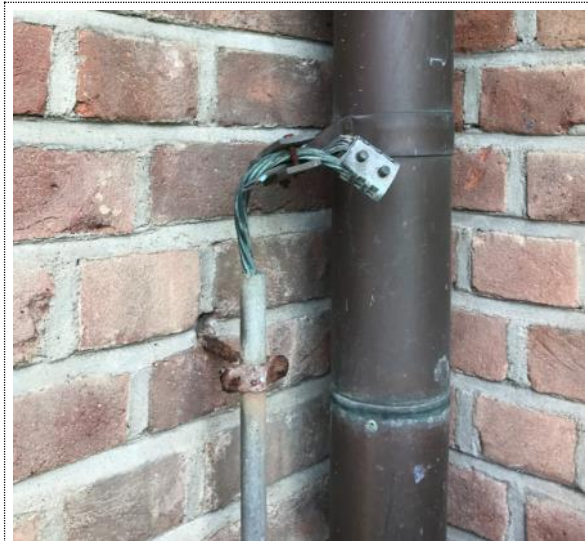
Bilde nr. RIE 10 Lynvern. Kraftig irr på kobberleder. Feste i veggen har løsnet.
