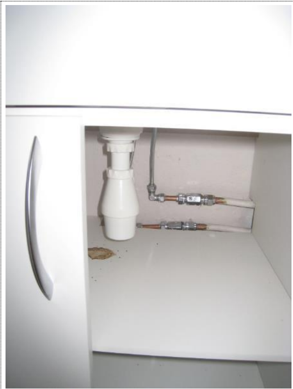
Bilde nr. RIV 27 Cu rør delvis innmurt. Dryppskade i skap.
