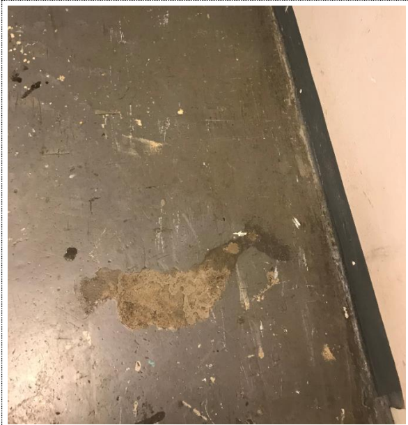
Bilde nr. RIB 18 Hull i gulvbelegg i korridor i kjeller.
