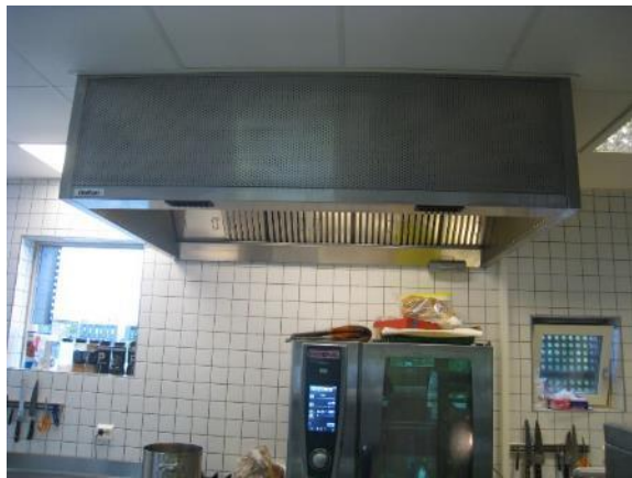
Bilde nr. RIV 35 Hette med fettfilter fra kantinekjøkken
