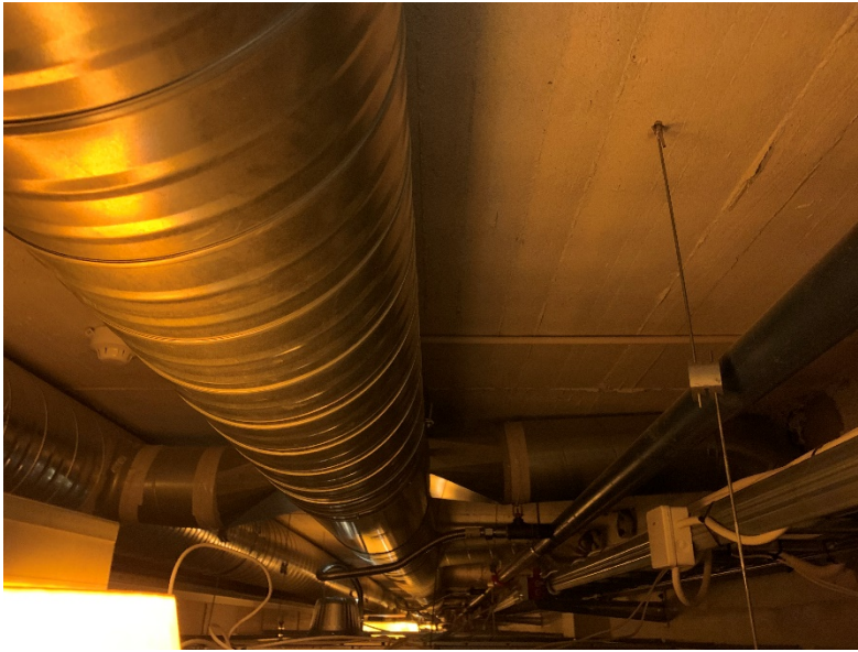
Bilde 3: Tekniske installasjoner over systemhimling i korridor
