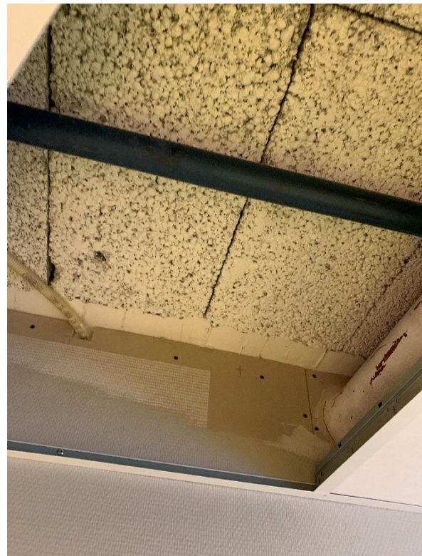
Bilde 5: Over systemhimling utenfor toalettavdeling
