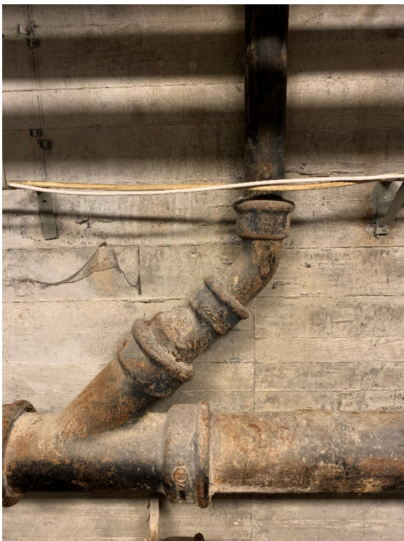
Bilde 12: Støpejern avløpsrør i kulvert kjeller
