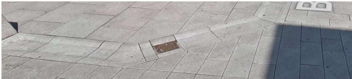
Figur 1: Eksempel på glatte overvannsrenner fra Fredrikstad sentrum.
