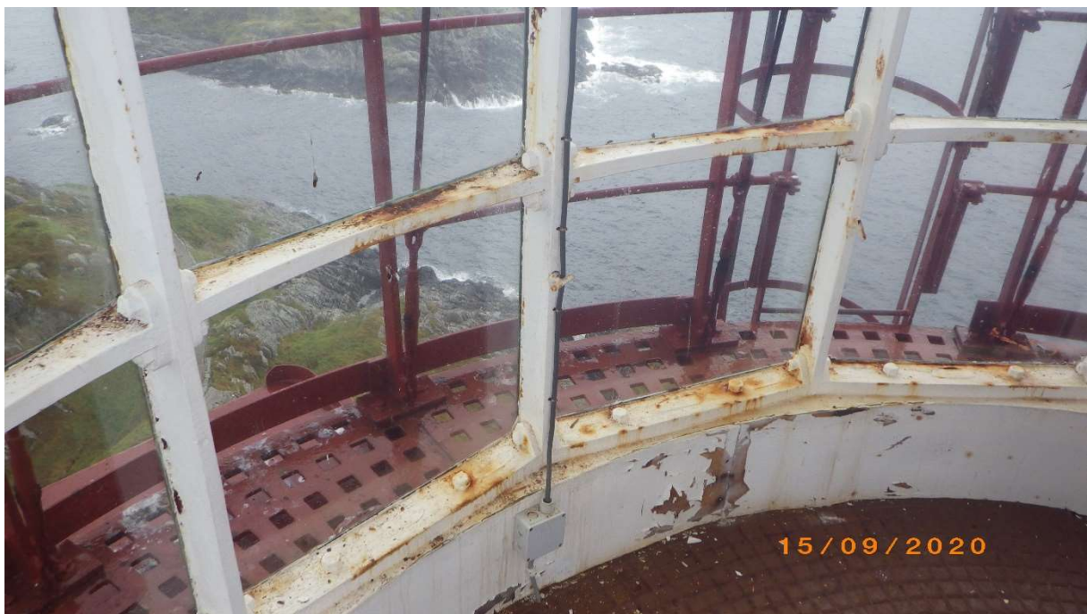
Bilde nr 12 – Innvendig i Lyktehus
