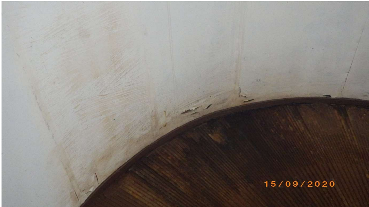
Bilde nr 17-Innvendig i lyktehus
