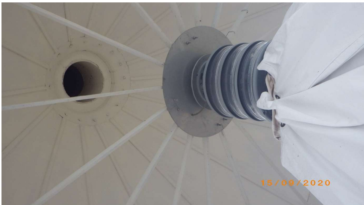
Bilde nr 18-Innvendig i lyktehus – innv tak.
