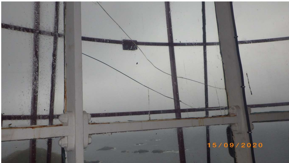
Bilde nr 14-Innvendig i lyktehus
