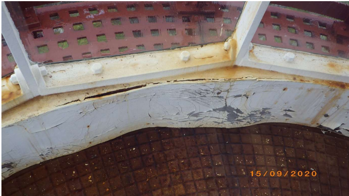
Bilde nr 13 – Innvendig i lyktehus
