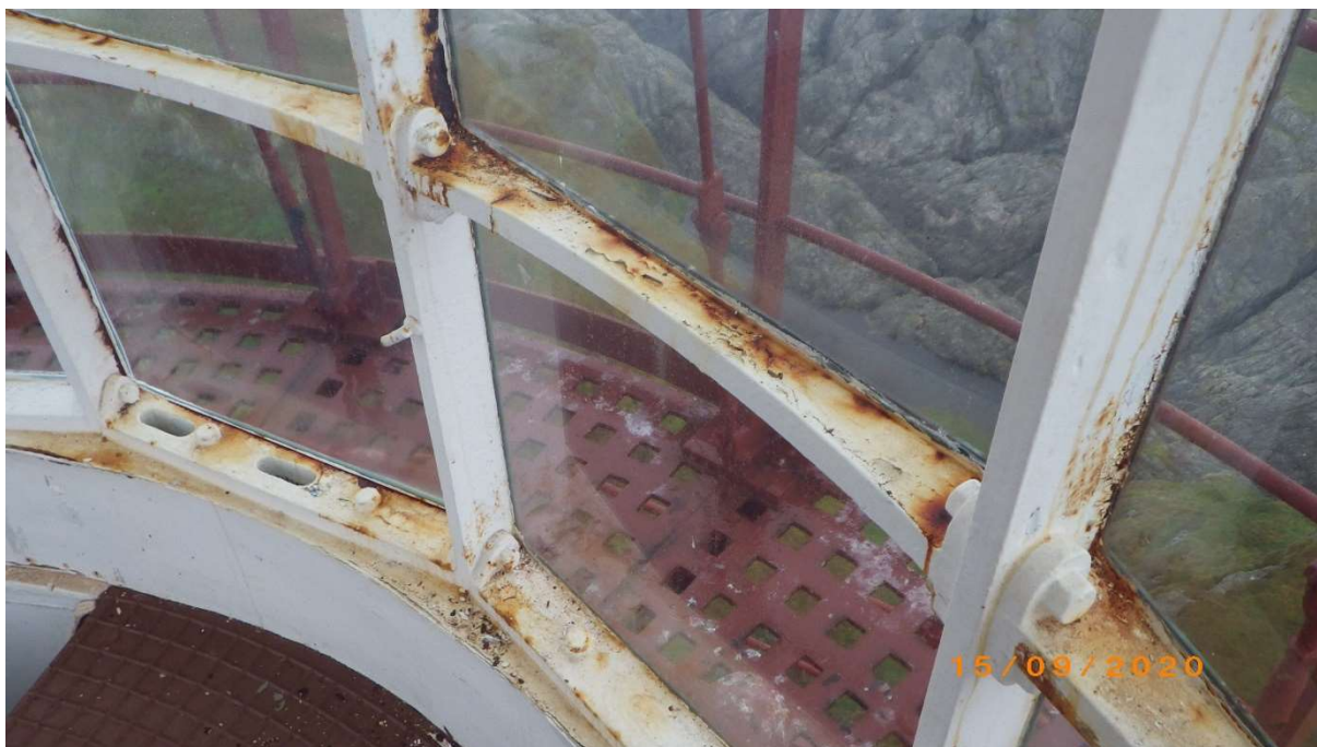
Bilde nr 15 – Innvendig i lyktehus
