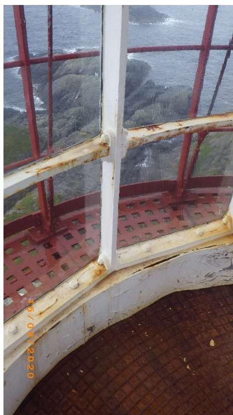
Bilde nr 16-Innvendig i lyktehus
