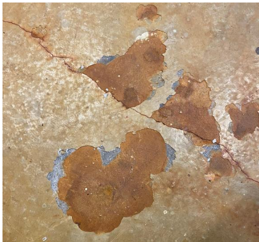
Bilde B1: Prøve nr P1 og P2: Betong og maling på gulv i bassengrommet.
