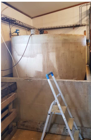
Figur 6: Eksisterende lagertank for JKL.
