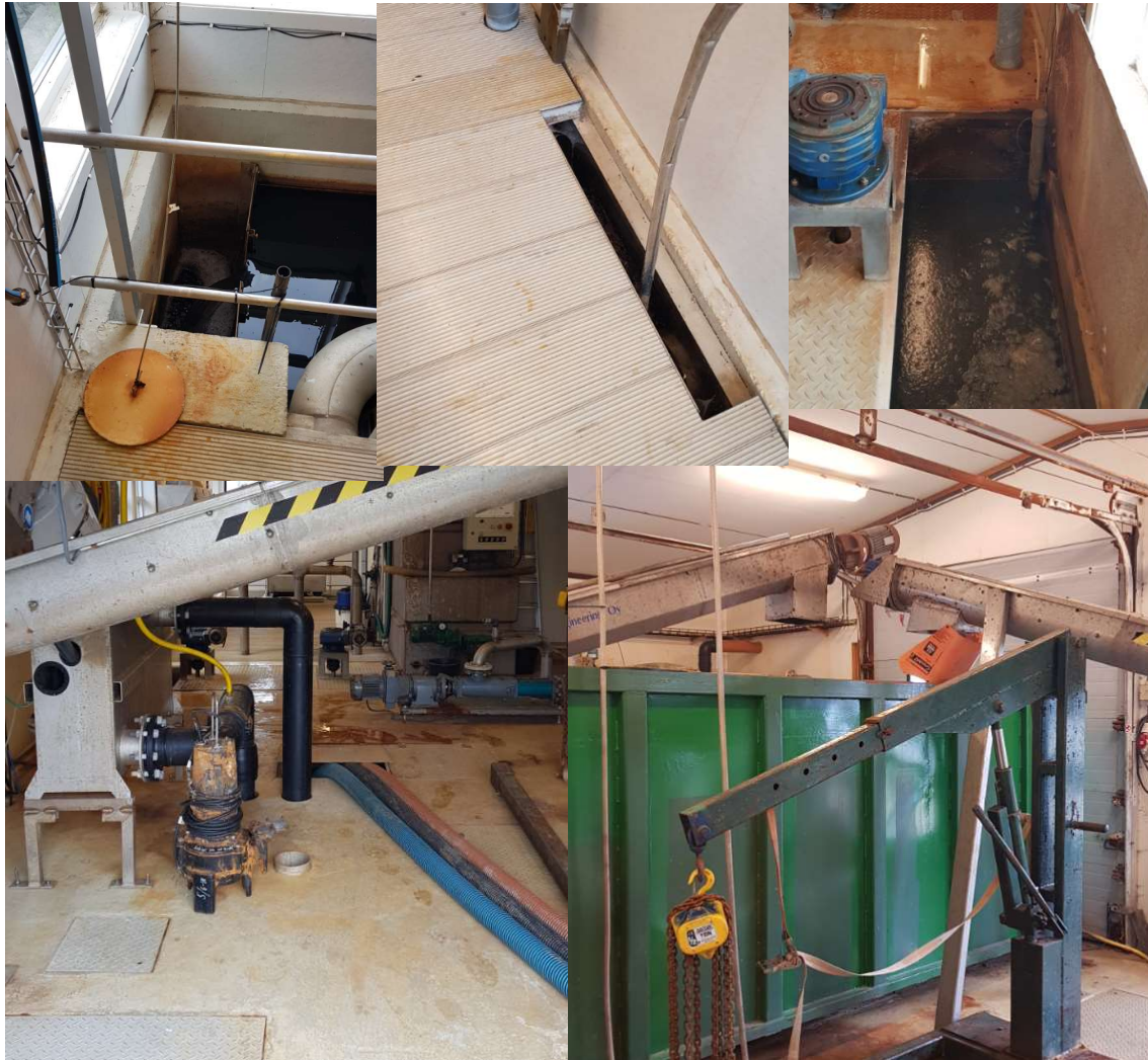
Figur 2: Bilder fra eksisterende renseanlegg.
