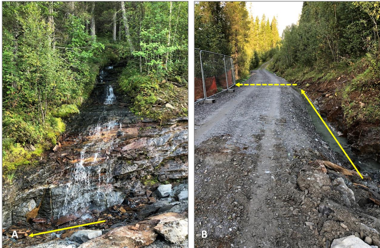
Figur 9. A) Utløpet av samme bekken som på Bilde 1B ved veien ovenfor anleggsområdet, bildet er tatt mot sør. B) Bekken er ledet i 90-graders vinkler mot baksiden av veien, bildet er tatt mot øst. Gule piler viser dreneringsretning.
