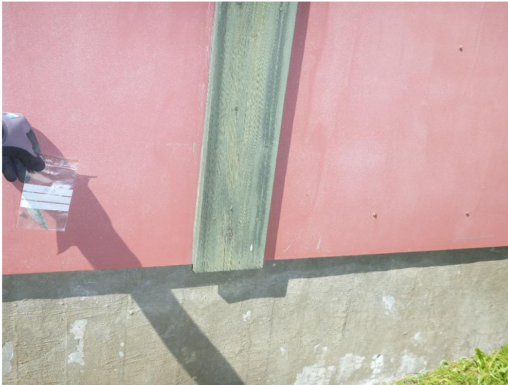
Asbestholdig eternitt på sørside
