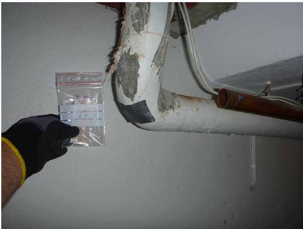
Asbestbend i rom 002
