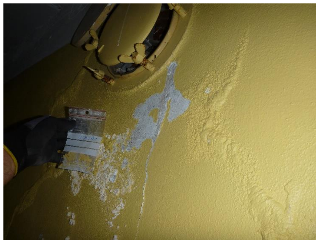
Rom 003: Gul maling inneholder litt PCB
