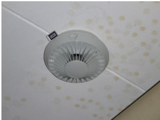
Røykdetektor, generelt i bygget.
