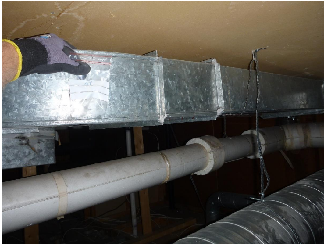
Kaldloft over D118, asbestholdig tettemasse.
