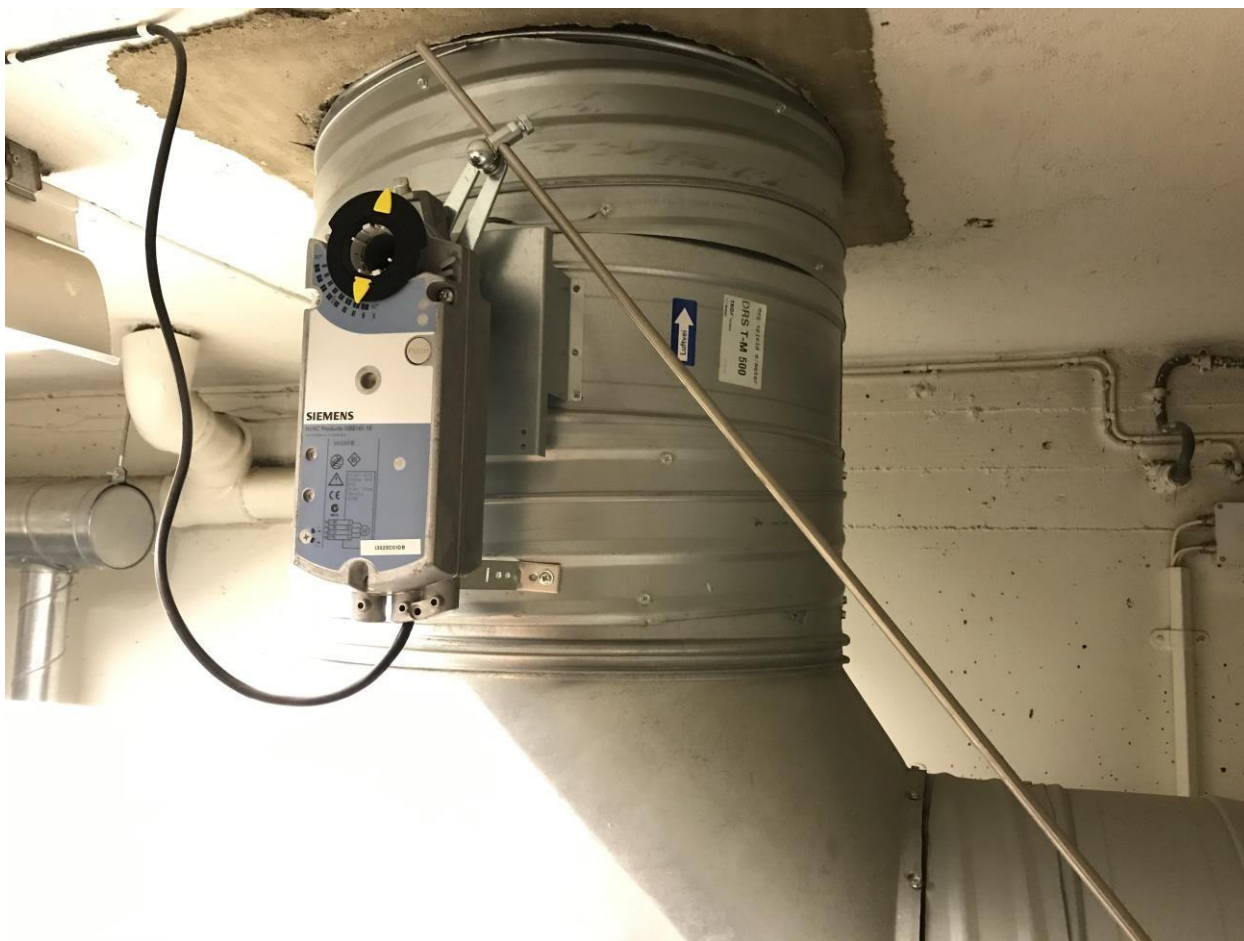
Figur 6 Bilde av motorstyrt spjeld på avkastkanal
