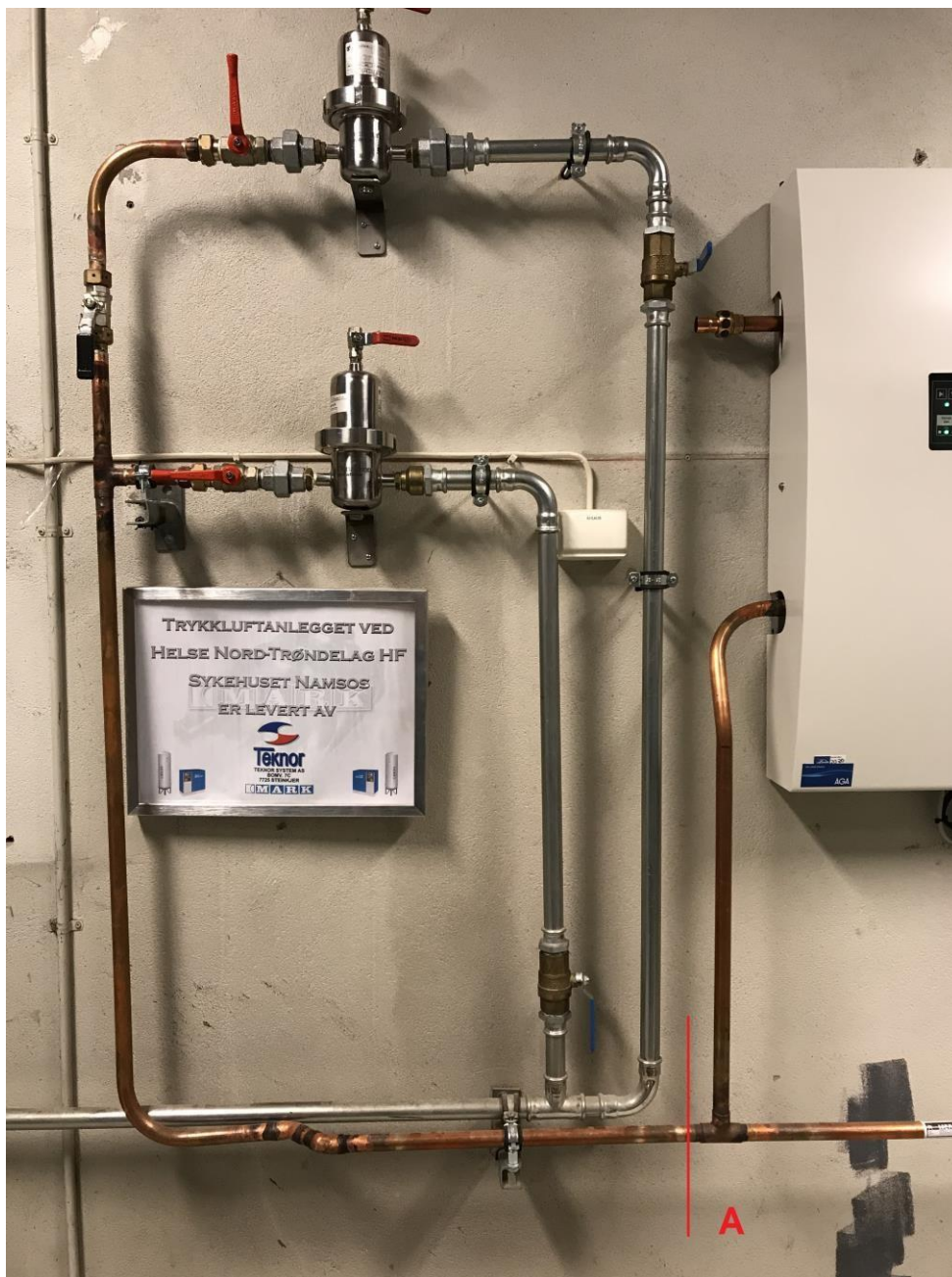
Figur 1 Bilde av eksisterende påkobling mot trykkstabilisatorer. Påkoblingspunkt i dette prosjektet er avmerket med A
