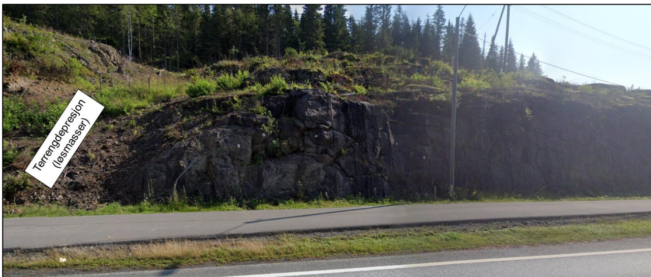
Figur 3-2: Oversiktsfoto med anvisning av ca. 10 m bred terrengdepresjon langs nordlig avgrensning av byggegroppen.
