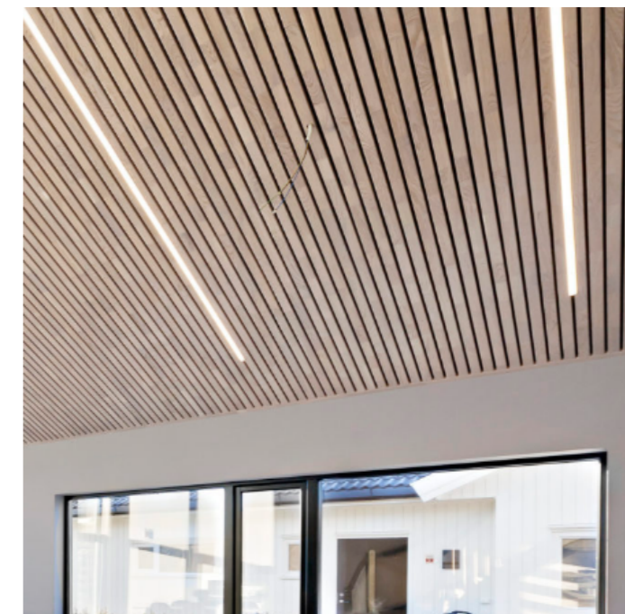
Eksempel på hvitlaserete eikespiler spiler i tak med innfelt belysning
