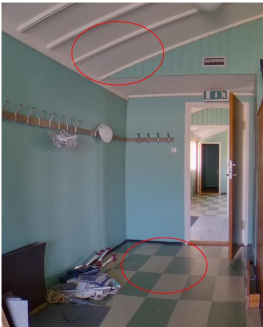
Bilde 5: Asbestholdige gulvbelegg og takplater i 2.etg
