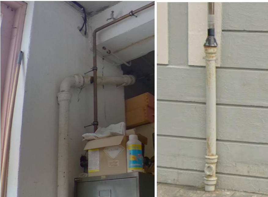
Bilde 6: Typiske rørskjøt med bly
