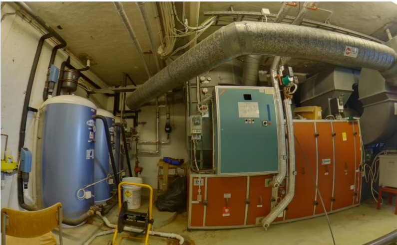
Bilde 11: Varmtvannstank og ventilasjonssystem
