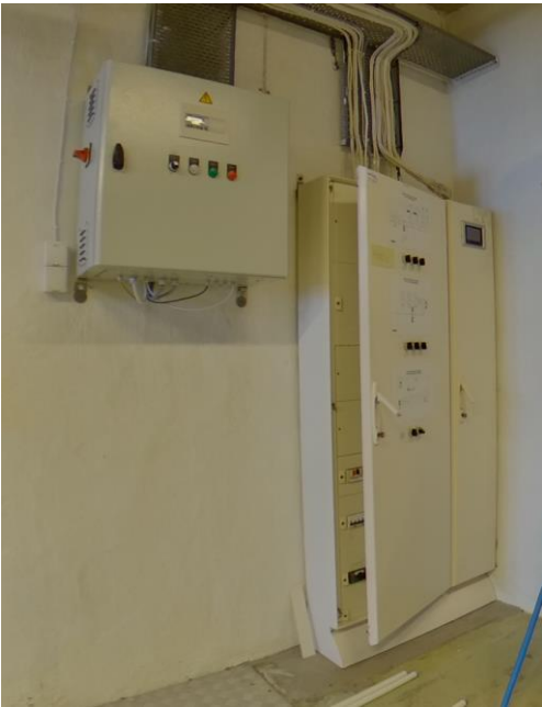
Bilde 10: Nye el-skap
