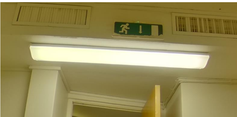
Bilde 13: Typiske lysarmaturer i bygget.
