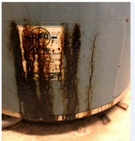
Figur 14: Bilder av varmtvannsbereder (og oljekjel) i fyrhus
