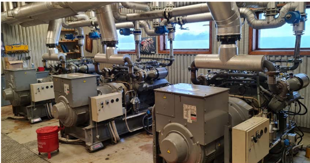
Figur 9: Bilde fra Diesel generatorrommet som viser de tre generatorene
