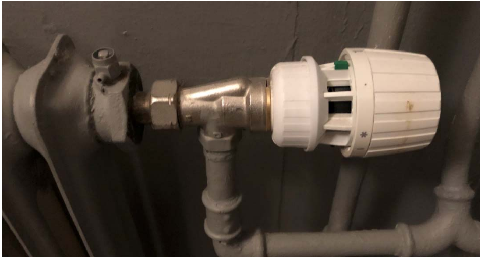
Figur 13: Bilde av en radiator termostatventil i bygget. Det kan være forskjellige typer.
