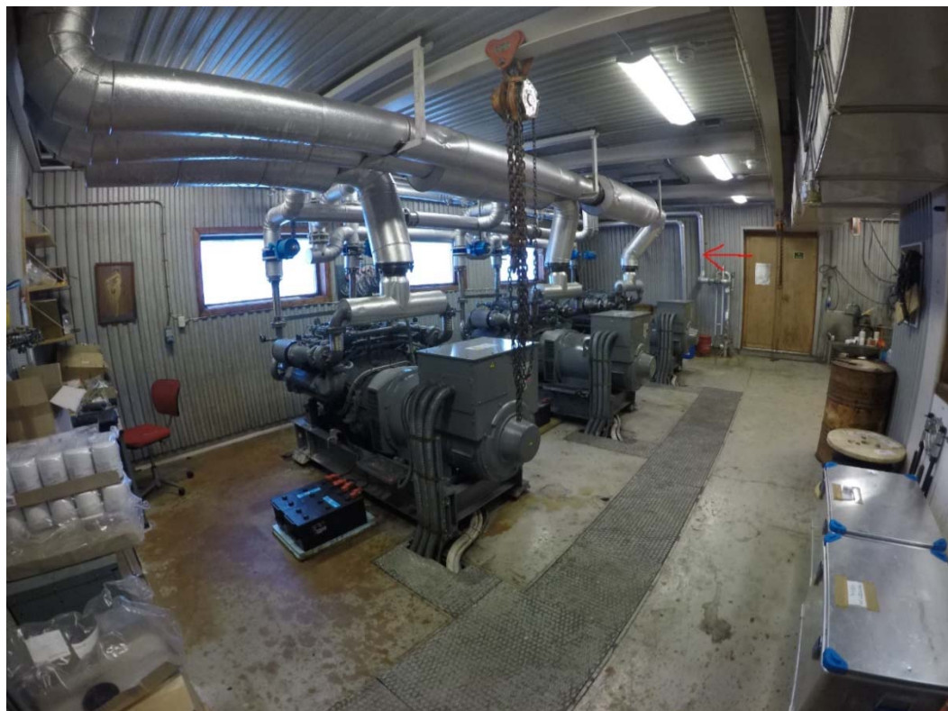
Figur 11: Bilde av generatorrom. Tilkopling av SB403 ventil og rør er vist på bildet med rød pil til venstre for døren i enden av rommet hvor også elektrokjel og pumper er planlagt plassert.
