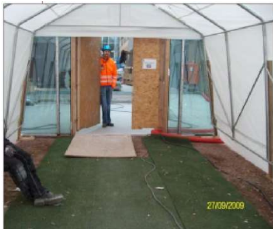
Figur 4: Adkomst til bygningen er tilrettelagt med sluse og matter
